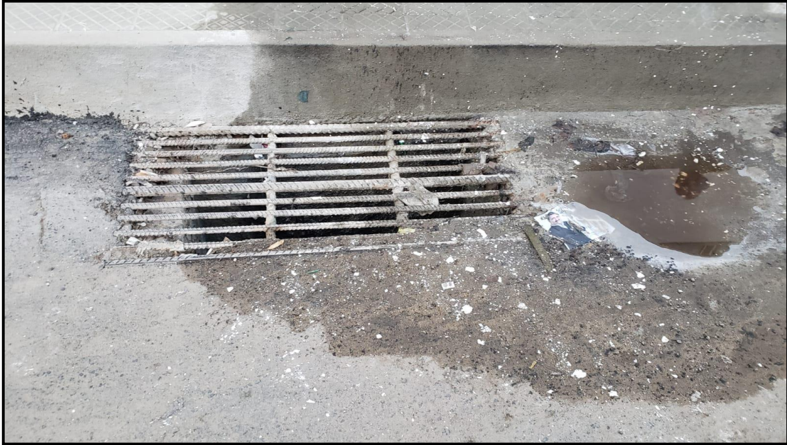
FIGURA 19 – Boca de Lobo da Av. Vicente Alves
