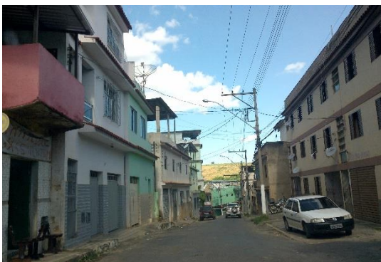
Figura 6.2-2: Desníveis nos Passeios
