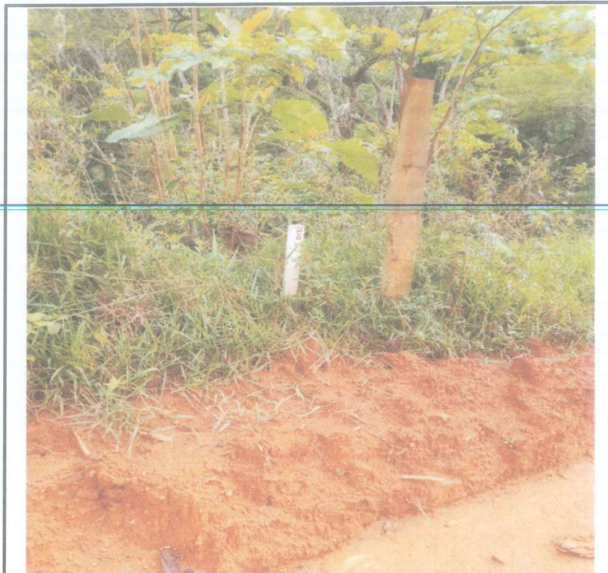
Foto 14 - Corte e aterro estaca 202 a 232 - remoção de cerca e corte de arvores
