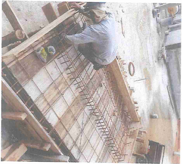
Observações: Foto 1: Montagem da forma e armação da escada de acesso a quadra.
