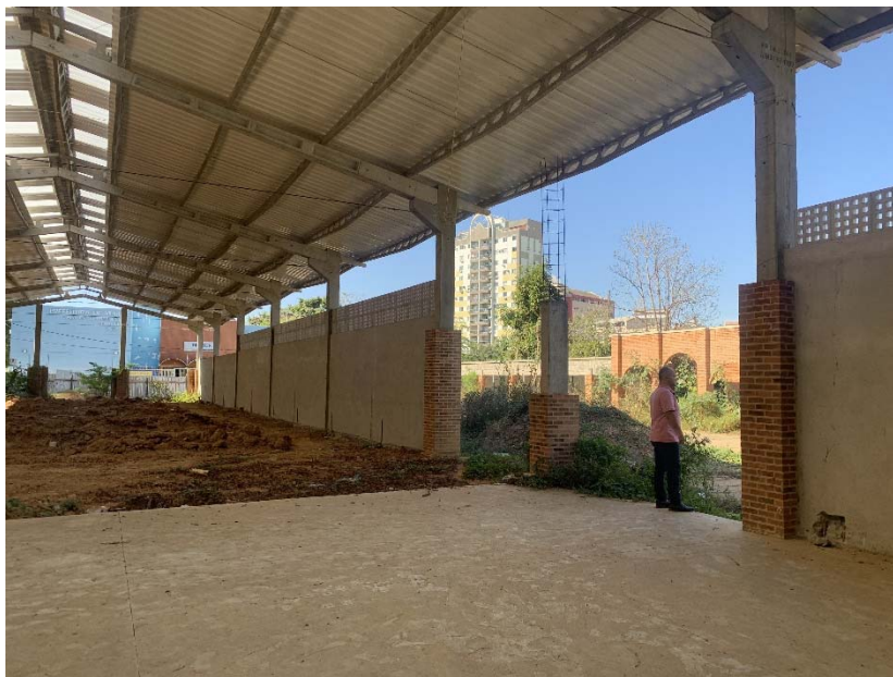
Figura 5: Visto que há complementações a se fazer de fechamento em cobogós e tijolo maciço aparente.
