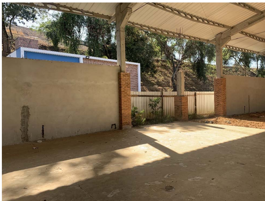
Figura 6: Visto que há complementações a se fazer de fechamento em cobogós e tijolo maciço aparente.
