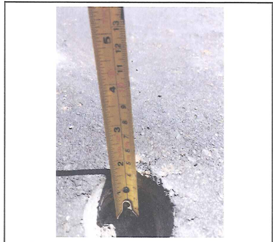
Foto 16 - Furo de inspeção - Estaca 166.
