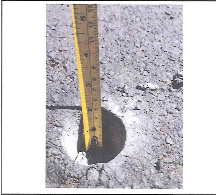
Foto 13 - Furo de inspeção - Estaca 188.
