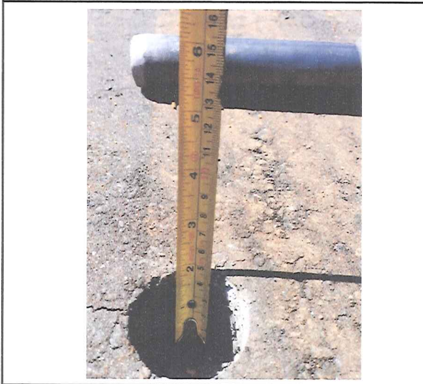
Foto 15 - Furo de inspeção - Estaca 204.
