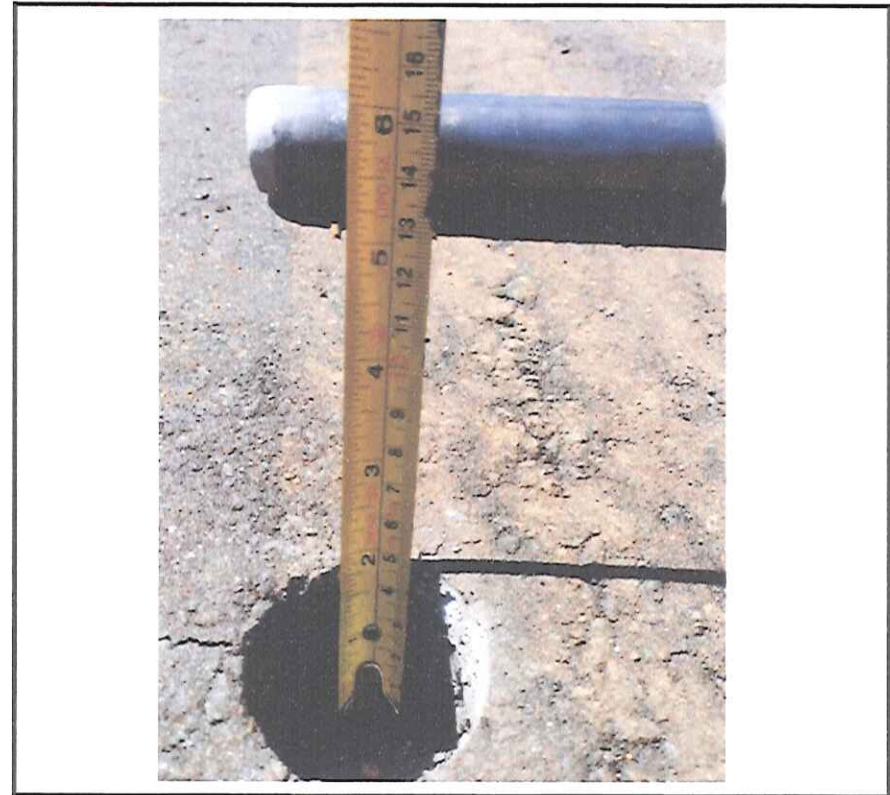
Foto 14 - Furo de inspeção - Estaca 222.
