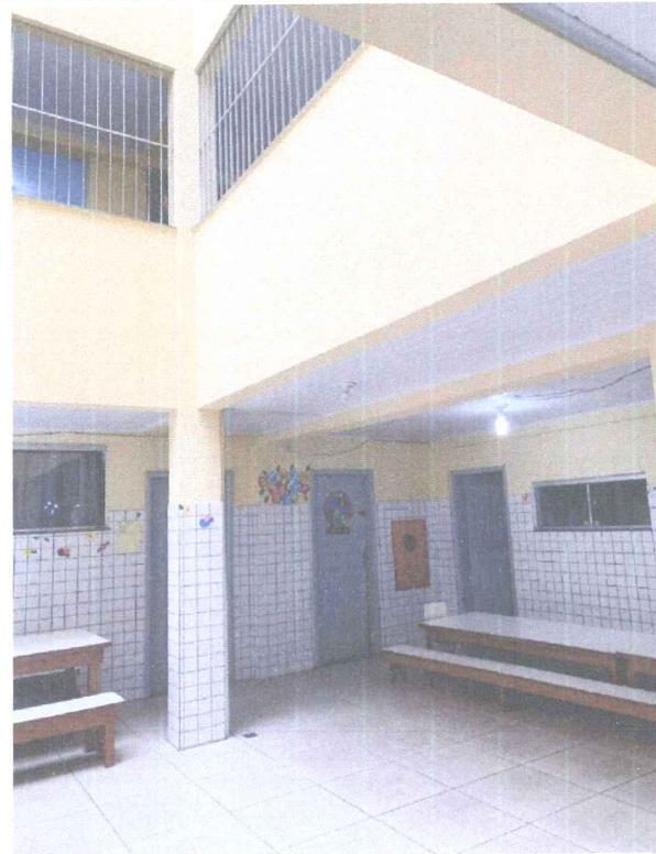
Foto 4: FORRO, PINTURA PAREDE E GRADE
