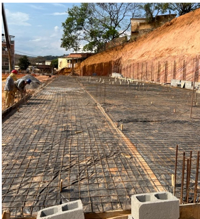
Imagem 12: lona e malha da laje de piso Fonte: arquivo próprio equipe fiscalização
