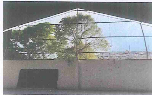
IMAGEM 2: REFORMA ANTIGO CEM REMOÇÃO DE ESTRUTURA E TELHAS LATERAIS E INSTALAÇÃO DE NOVAS
