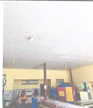
IMAGEM 2: MANUTENÇÃO E. M. MARIA DO CARMO C. CASTRO LOCAL: FORRO
