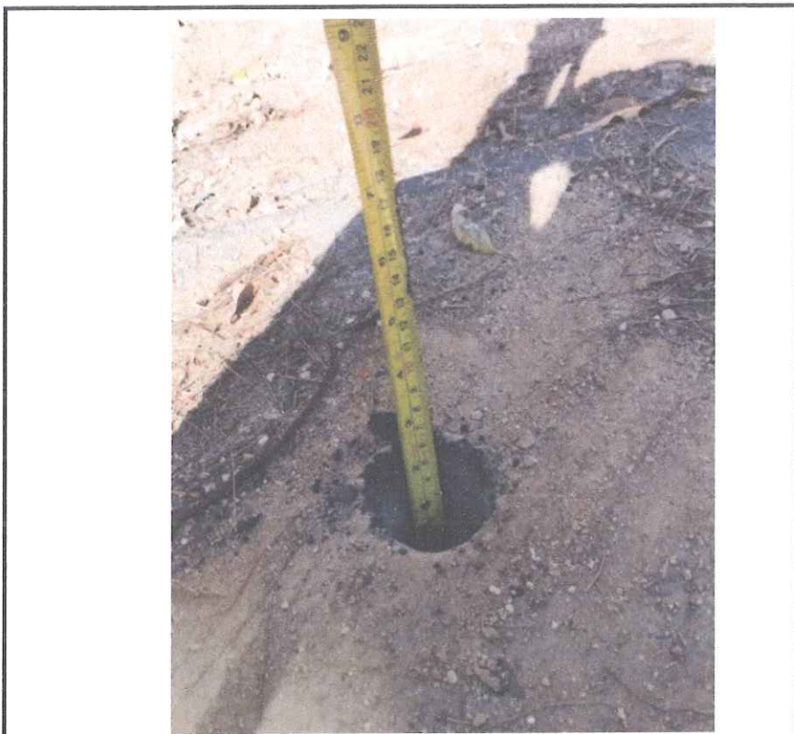
Foto 21 - Furo de inspeção - Estaca 197.
