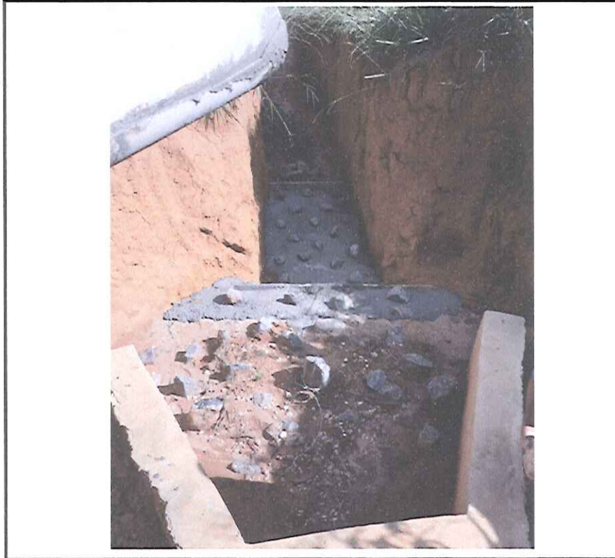
Foto 03 - Dissipador de energia
