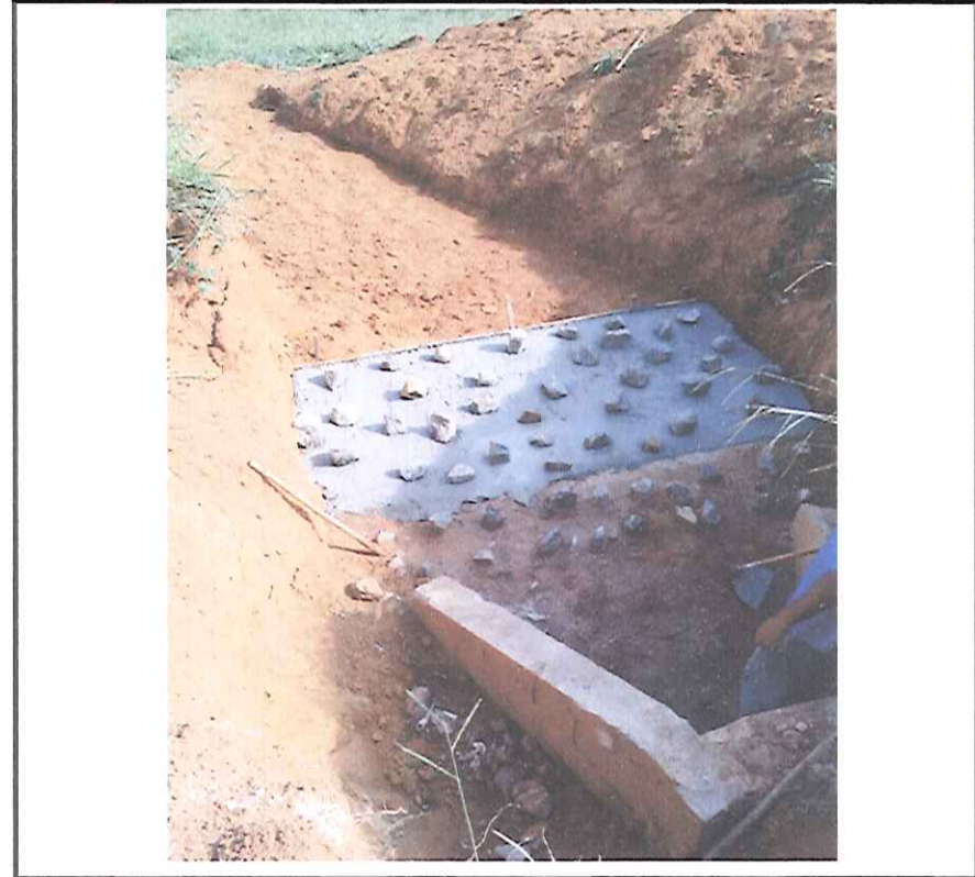
Foto 04 - Dissipador de energia
