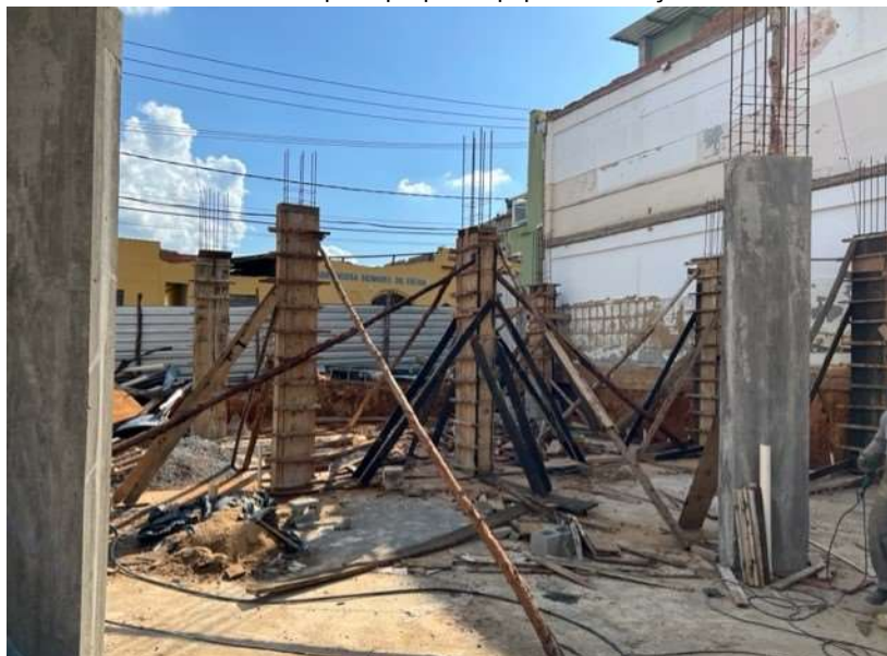
Imagem 13: concretagem dos blocos de coroamento e vigas Fonte: arquivo próprio equipe fiscalização
