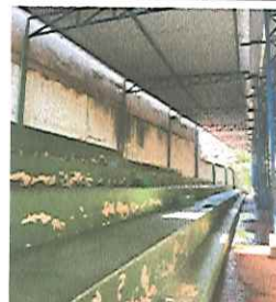
IMAGEM 2: AUSENCIA DE RUFO PAREDE DE DIVISA, PINTURA DA ARQUIBANCADA DANIFICADA LOCAL: E.M. GILBERTO JOSE TANUS BRAZ
