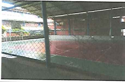
IMAGEM 5: ALAMBRADO DANIFICADO LOCAL: E.M. GILBERTO JOSE TANUS BRAZ
