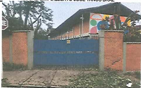
IMAGEM 3: MURO DANIFICADO LOCAL: E.M. GILBERTO JOSE TANUS BRAZ
