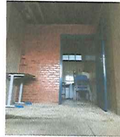
IMAGEM 6: AUSÊNCIA DE FORRO NO BANHEIRO PCD TERREO LOCAL: E.M. GILBERTO JOSE TANUS BRAZ
