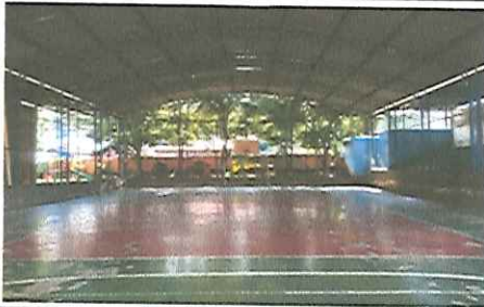
IMAGEM 1: PINTURA QUADRA DESGASTADA, TELHAS DANIFICADAS LOCAL: E.M. GILBERTO JOSE TANUS BRAZ
