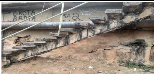
IMAGEM 3: ESTRUTURA DA ESCADA ESPINHA DE PEIXE COM FERRAGEM APARENTE LOCAL: BAIRRO SANTA TEREZINHA
