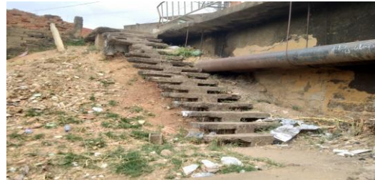
IMAGEM 2: ESCADA ESPINHA DE PEIXE COM DEGRAUS QUEBRADOS LOCAL: BAIRRO SANTA TEREZINHA
