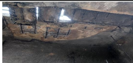
IMAGEM 4: LAJE DO TOPO DA ESCADA ESPINHA DE PEIXE DANIFICADA E COM FERRAGEM APARENTE LOCAL: BAIRRO SANTA TEREZINHA
