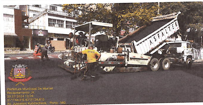
Prefeitura Municipal De Muriaé Recapamento JK 29.07.2024 12:08 21.744.318 42.21.27.02"O Av. Juscelino Kubitschek - Porto - MG
