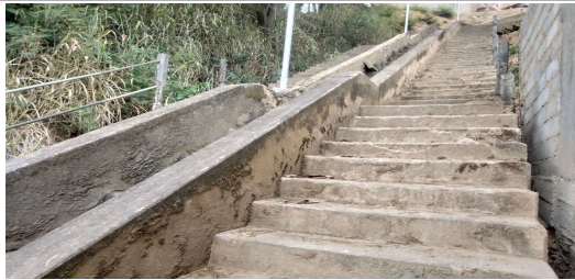
IMAGEM 1: AUSÊNCIA DE GUARDA-CORPO EM GRANDE PARTE DO ESCADÃO LOCAL: BAIRRO SANTA TEREZINHA
