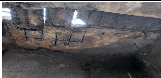
IMAGEM 4: LAJE DO TOPO DA ESCADA ESPINHA DE PEIXE DANIFICADA E COM FERRAGEM APARENTE LOCAL: BAIRRO SANTA TEREZINHA
