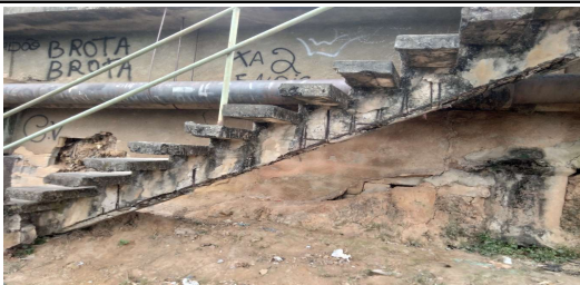
IMAGEM 3: ESTRUTURA DA ESCADA ESPINHA DE PEIXE COM FERRAGEM APARENTE LOCAL: BAIRRO SANTA TEREZINHA
