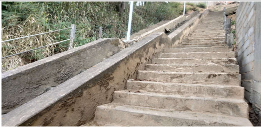
IMAGEM 1: AUSÊNCIA DE GUARDA-CORPO EM GRANDE PARTE DO ESCADÃO LOCAL: BAIRRO SANTA TEREZINHA
