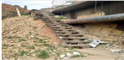
IMAGEM 2: ESCADA ESPINHA DE PEIXE COM DEGRAUS QUEBRADOS LOCAL: BAIRRO SANTA TEREZINHA
