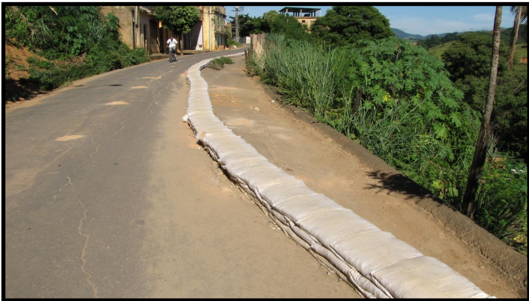
Foto 190 – Detalhe para um trecho da Rua Francisco T. Filho parcialmente rompido com possibilidade de novos colapsos.
