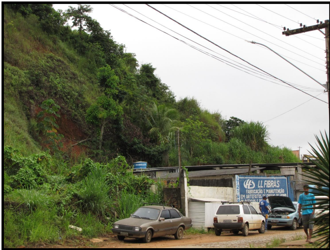
Foto 85 – Vista parcial do setor com detalhe para os cortes verticalizados e a ocupação da base com afastamento mínimo em relação a face do talude.
