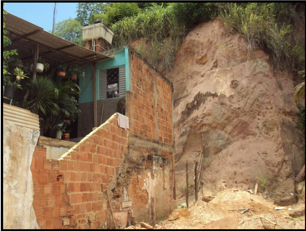
Foto 160 – Lote com domicílio em construção. Solo residual muito alterado e geometria inadequada do talude.
