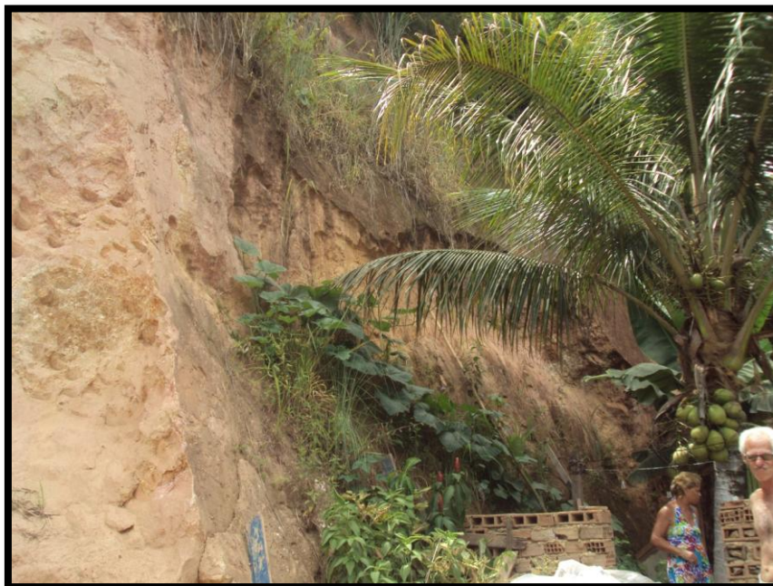
Foto 159 – Detalhe para corte verticalizado em material instável nos fundos de dois domicílios sendo que um está sendo construído. Solo residual muito alterado.
