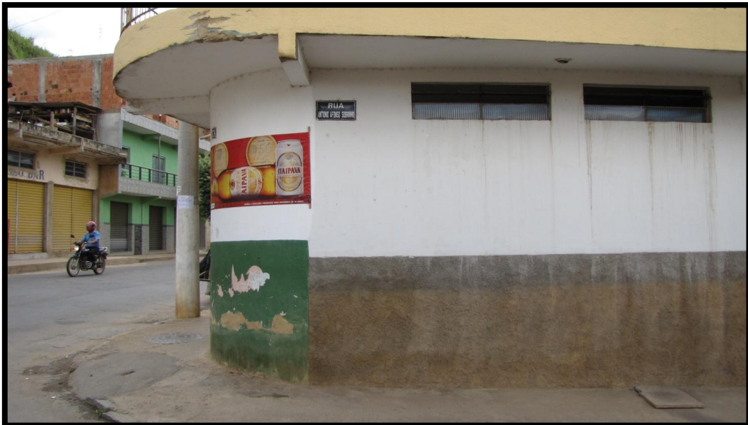
Foto 66 – Rua Antônio Afonso Sobrinho e marca nas paredes com altura de 1,0m do último episódio de inundação no local.
