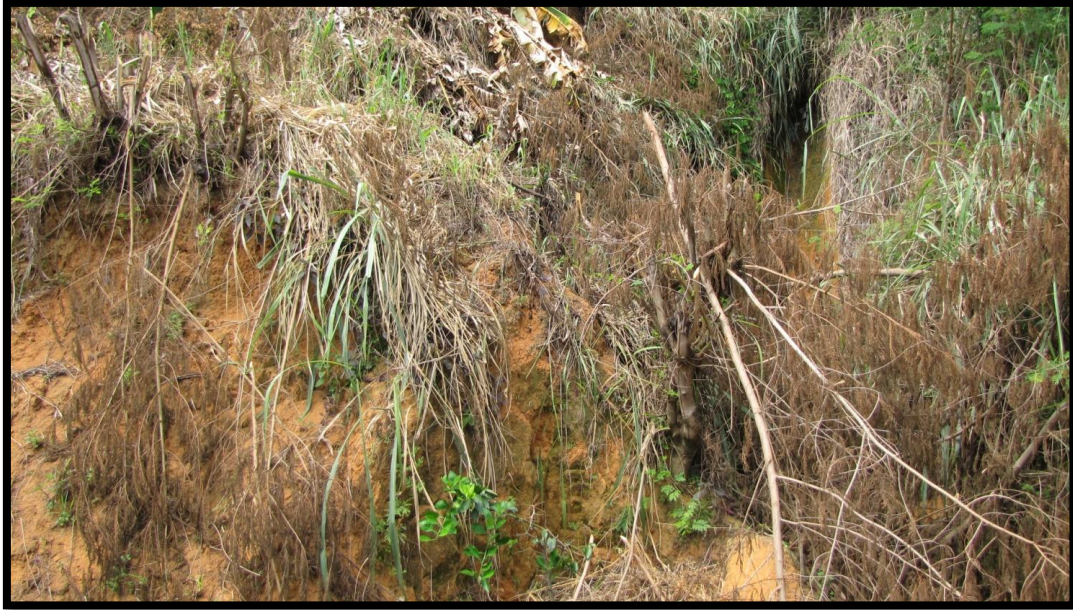
Foto 93 – Detalhe para feição erosiva esculpida na encosta em decorrência do lançamento do sistema de drenagem superficial diretamente na encosta.
