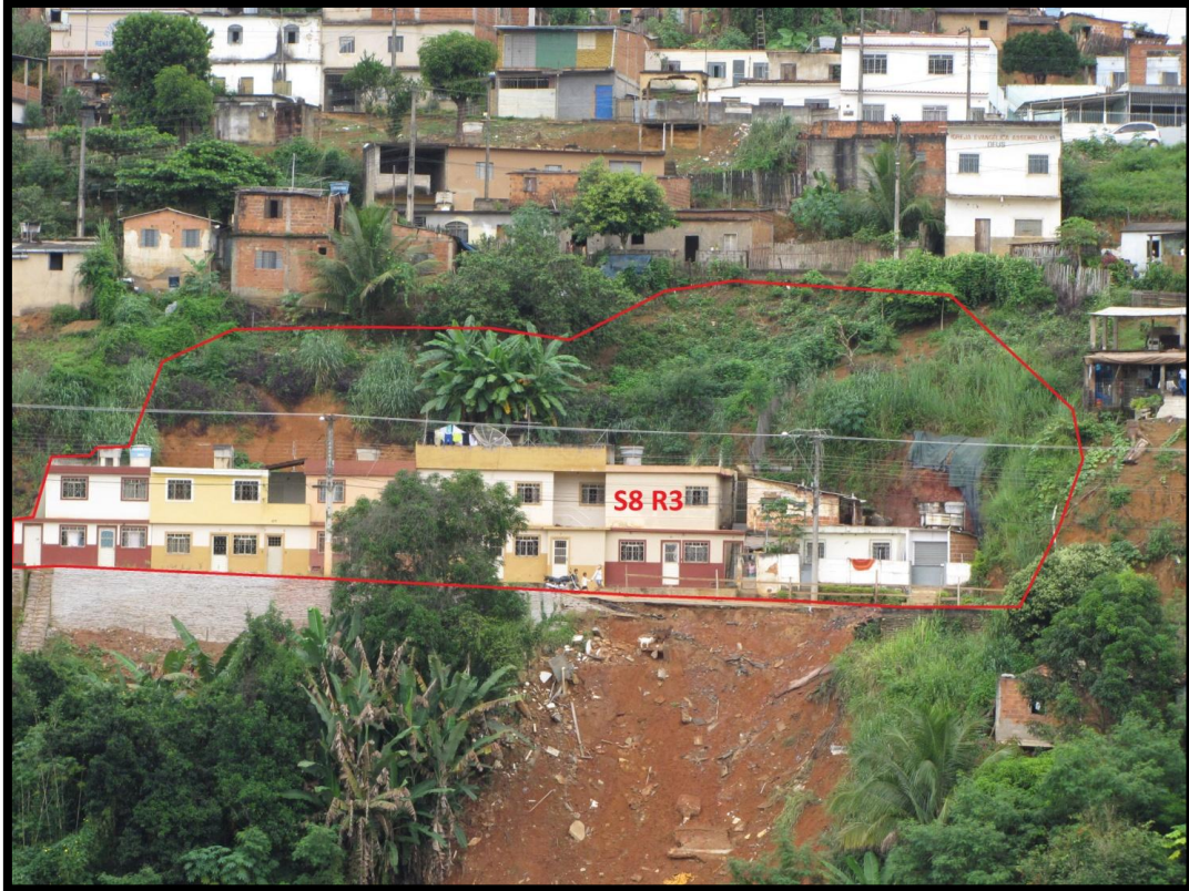
Foto 14 – Vista frontal do setor 8 de risco geológico com detalhe para o desnível elevado entre as faixas ocupadas da base e da crista e para os cortes verticalizados com alturas superiores a 8,0m nos fundos dos domicílios da base.
