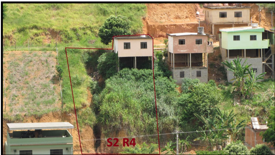
Foto 53 – Vista frontal do setor de risco geológico. Notar feição erosiva de grande porte adjacente ao domicílio.
