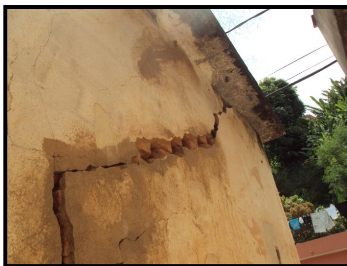
Foto 71 – Danos estruturais no domicílio ilustrado na foto anterior.
