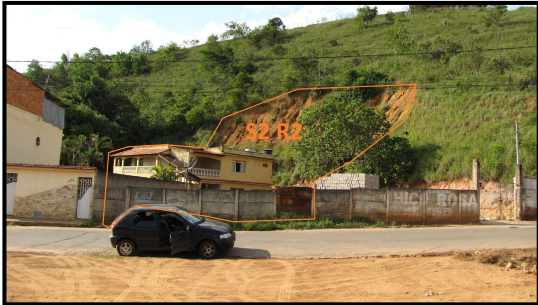
Foto 58 – Vista frontal do setor de risco geológico. Detalhe para as feições erosivas ao longo da encosta a montante do domicílio.
