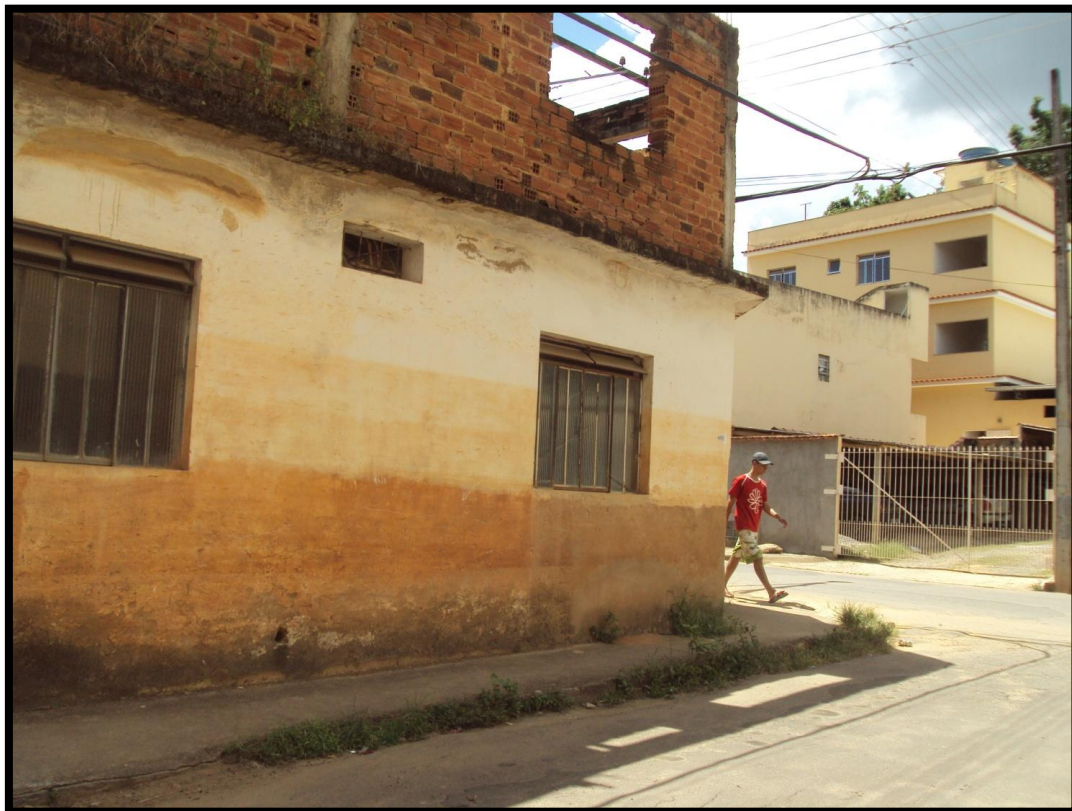
Foto 109 – Outro domicílio do setor com marcas do último episódio de inundação.
