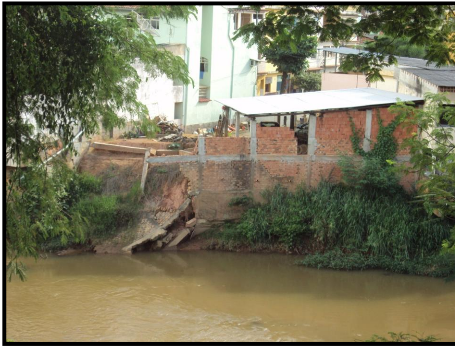
Foto 39 – Colapso da estrutura adjacente ao Rio Muriaé.
