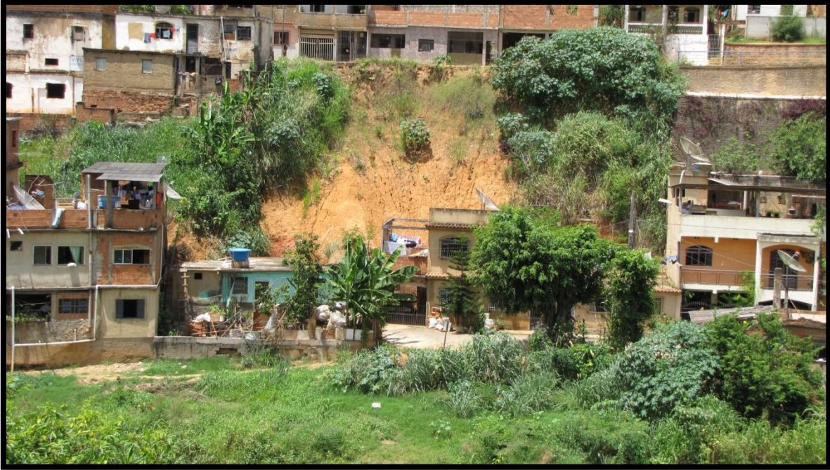
Fotos 69 – Detalhe para a ocupação da base, o desnível e inclinação, a presença de uma camada de aterro an crista, nas bordas da via veicular e um cicatriz de escorregamento de grande porte.
