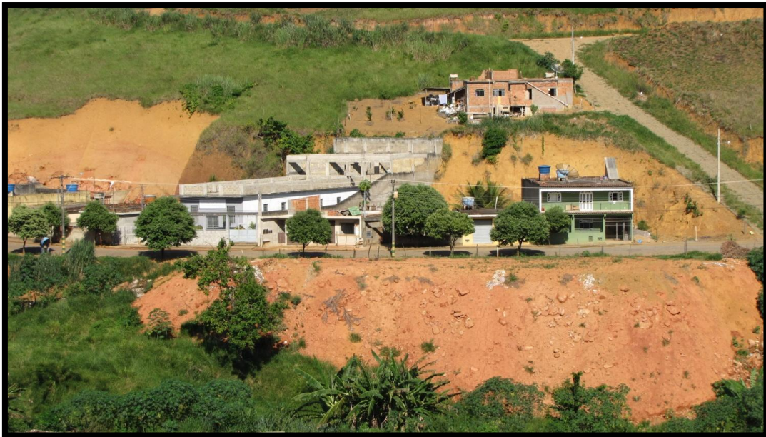
Foto 138 – Vista parcial do setor de risco com destaque para o talude de corte verticalizado com altura de 8,0m nos fundos de dois domicílios.
