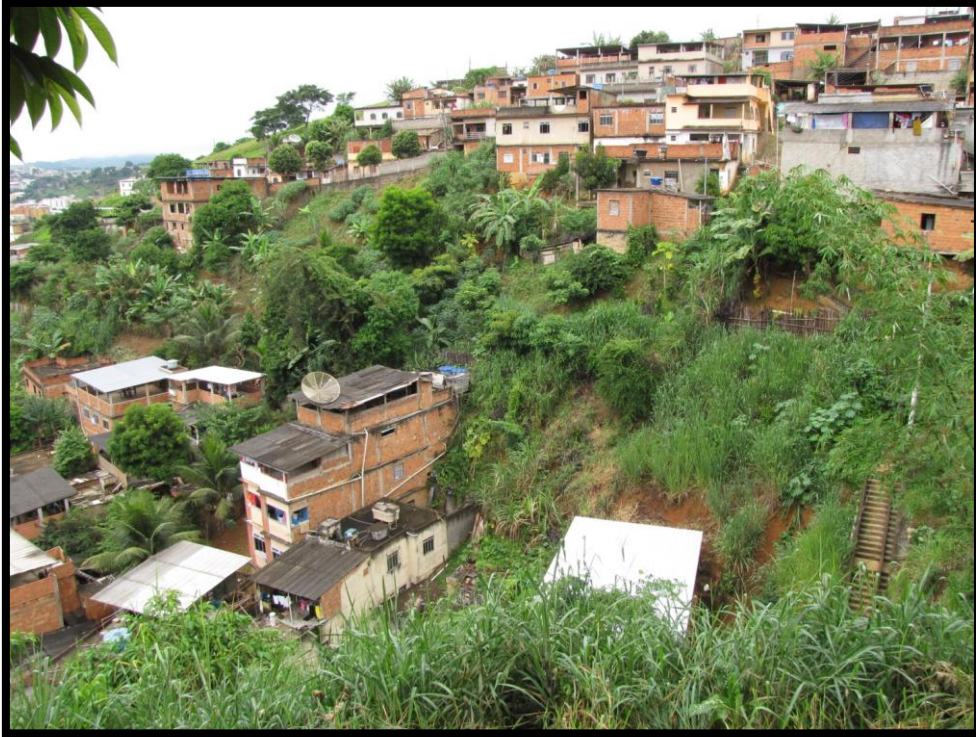
Foto 81 – Vista oposta da foto anterior. Nos fundos do domicílio a direita da foto próximo a escadaria já ocorreram escorregamentos de solo e tem-se a possibilidade de deflagração de novos movimentos de massa.
