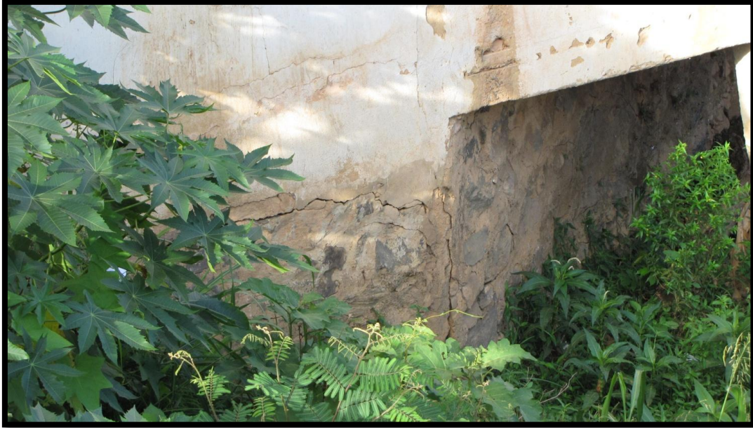
Foto 117 – Trincas na base dos domicílios – muros de pedra argamassada.
