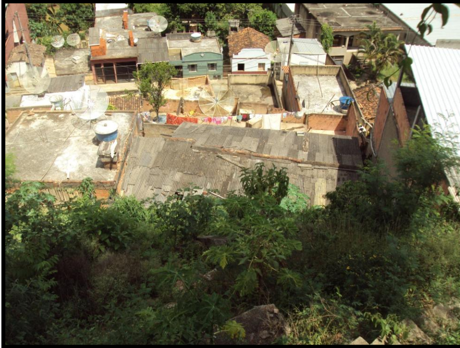
Foto 162 – Detalhe a partir da estrutura rompida ilustrada na foto anterior para o terreno a jusante da mesma onde há possibilidade de ocorrerem escorregamento inclusive mobilizando parte da estrutura rompida.
