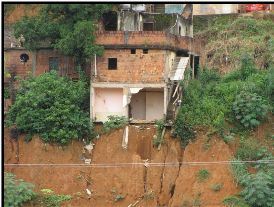
Foto 11 – Detalhe específico para o domicílio que estava em vias de ser demolido após colapso parcial do mesmo. Notar feições erosivas sob e no entorno da edificação.
