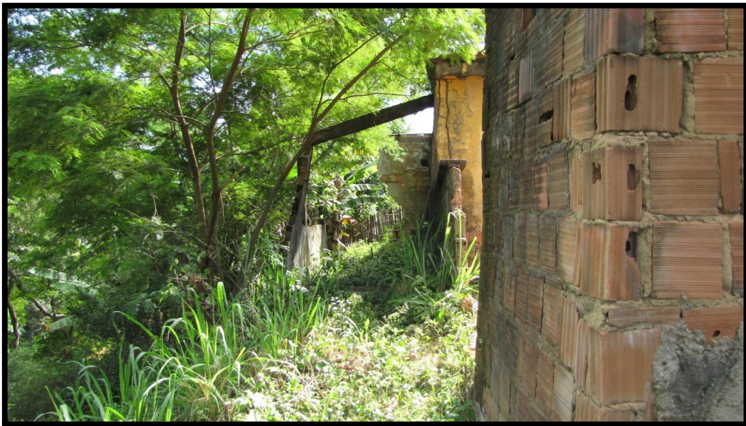
Foto 75 – Vista dos fundos dos domicílios do setor de risco. Detalhe para a alvenaria aparente e o baixo padrão construtivo.
