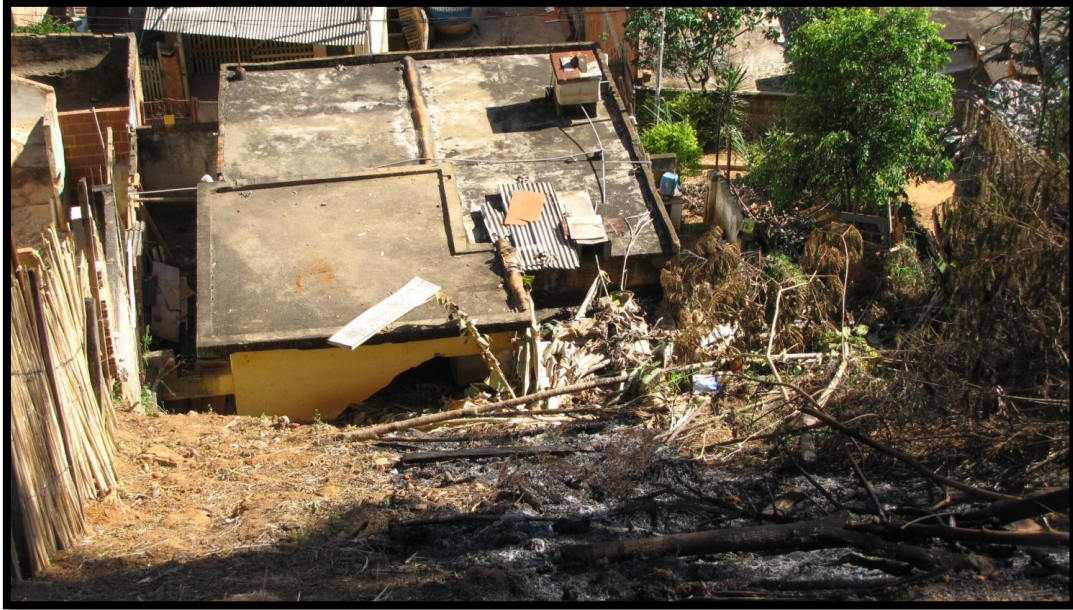
Foto 191 – Detalhe para o terreno nos fundos de um dos domicílios do setor onde já ocorreram escorregamentos que atingiram e danificaram o mesmo.
