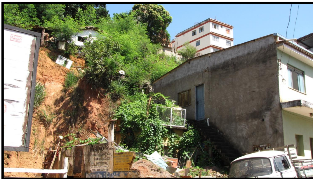
Foto 152 – Vista complementar do setor de risco. Domicílio de baixo padrão construtivo na crista do talude instável.
