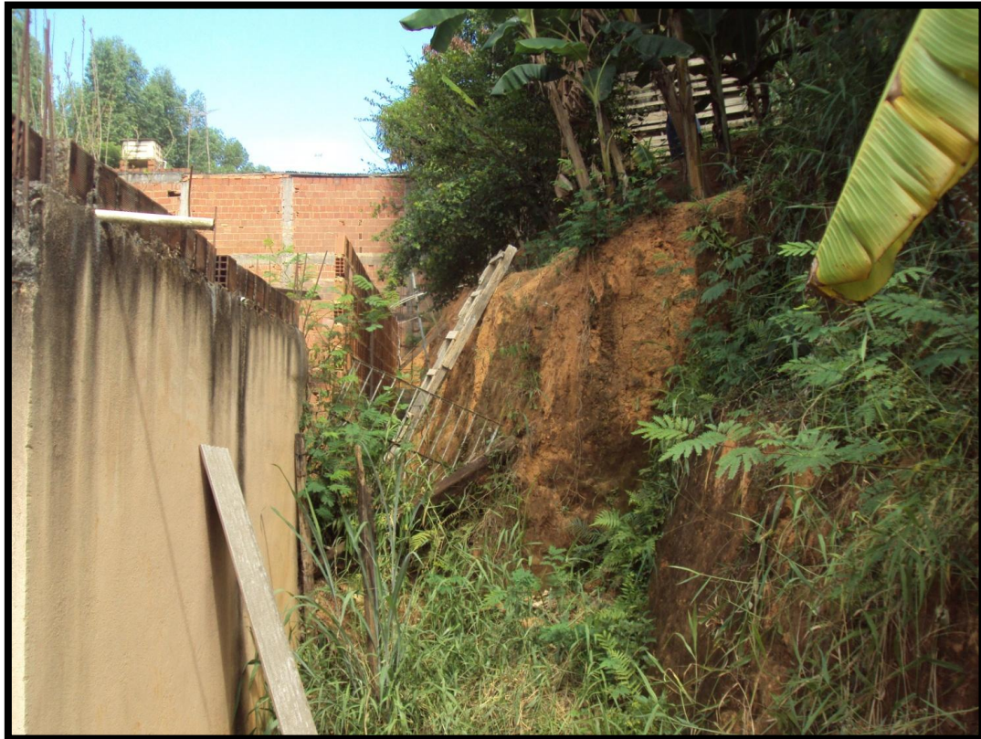
Foto 101 – Fundos de um dos domicílios com detalhe para o afastamento pequeno entre o domicílio e a face do talude.
