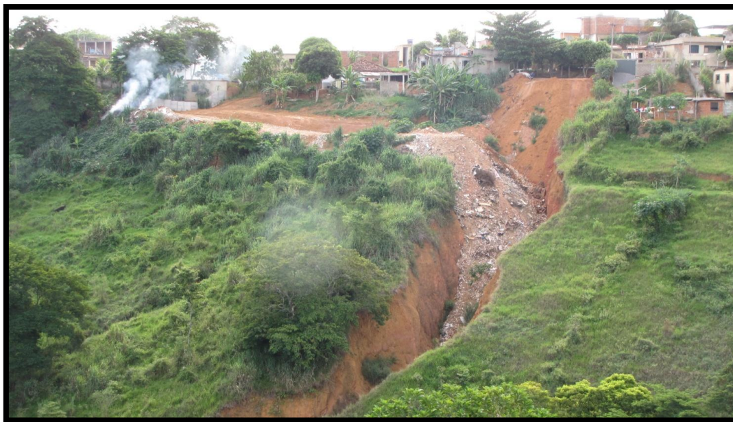
Foto 134 – Vista frontal do mesmo local posterior ao trabalho de campo ilustrado na foto anterior com detalhe para o lançamento de entulho e lixo ao longo da feição erosiva.
