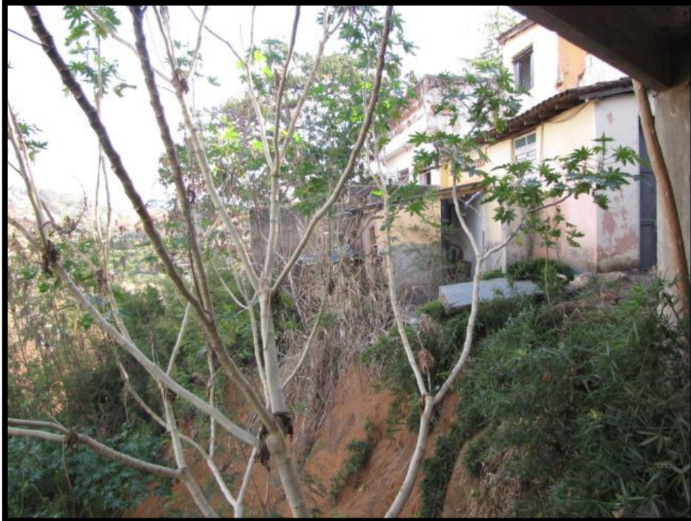
Foto 150 – Detalhe para a o domicílio parcialmente danificado após a deflagração de movimentos de massa.
