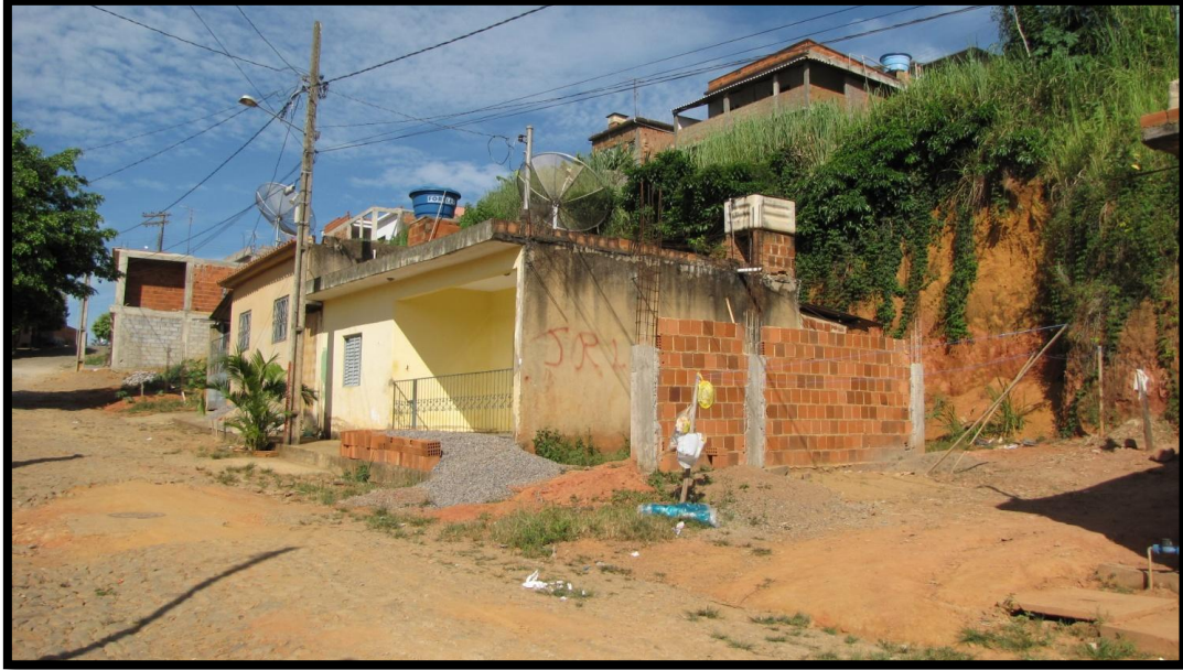
Foto 170 – Vista parcial do setor e da Rua Maria da Conceição Oliveira. Detalhe para a ocupação a partir de cortes verticalizados com alturas de até 4,0m.
