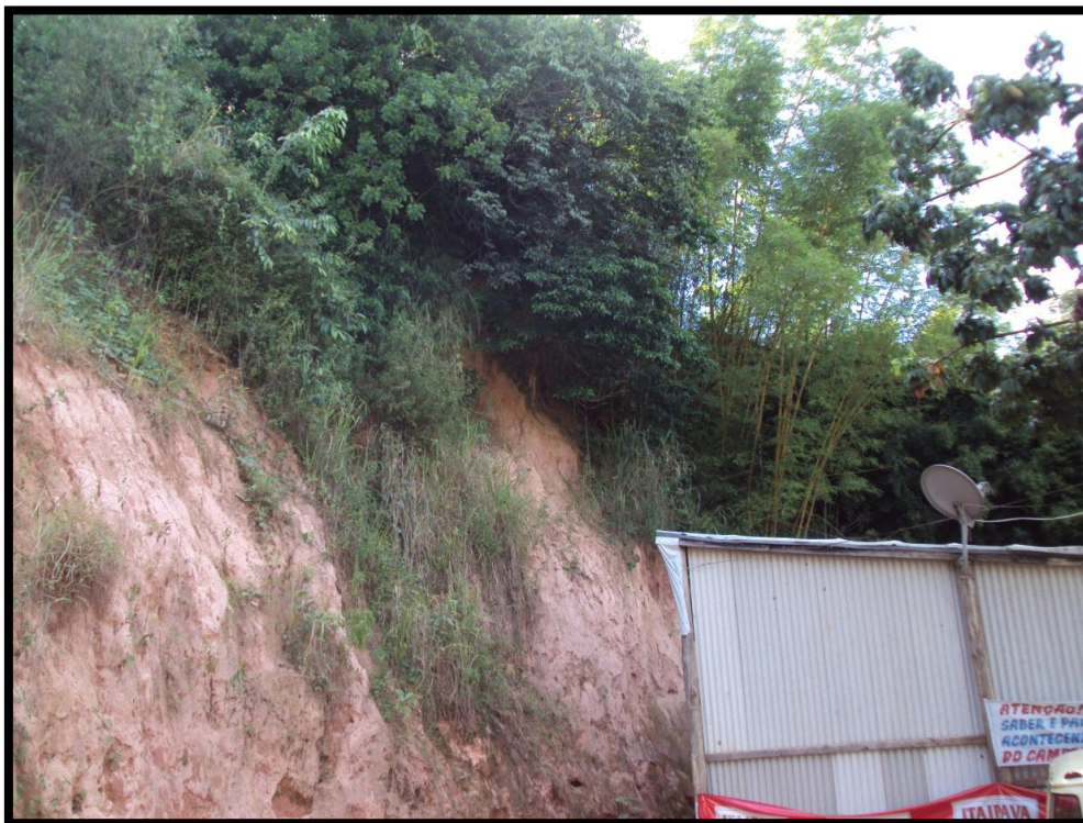
Foto 202 – Vista parcial do setor com detalhe para talude de corte verticalizado.
