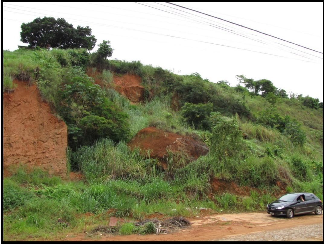
Foto 86 – Detalhe para bloco rochoso que se desprende do maciço rochoso e atingiu a base da encosta em um trecho não ocupado.
