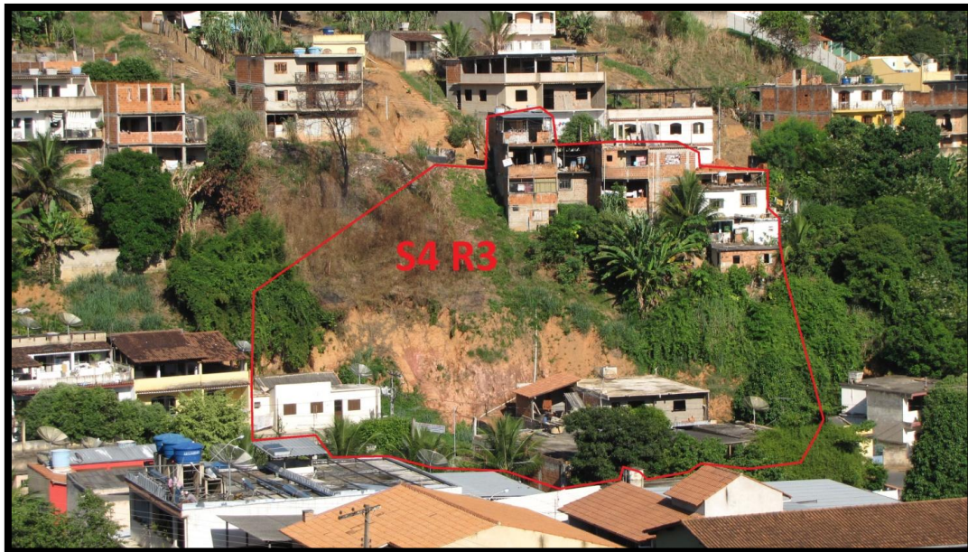
Foto 129 – Delimitação do setor de risco geológico com destaque para o desnível acentuado entre a base e o topo, a inclinação do talude de corte, a proximidade dos domicílios da base em relação a face do talude e a existência de bananeiras.
