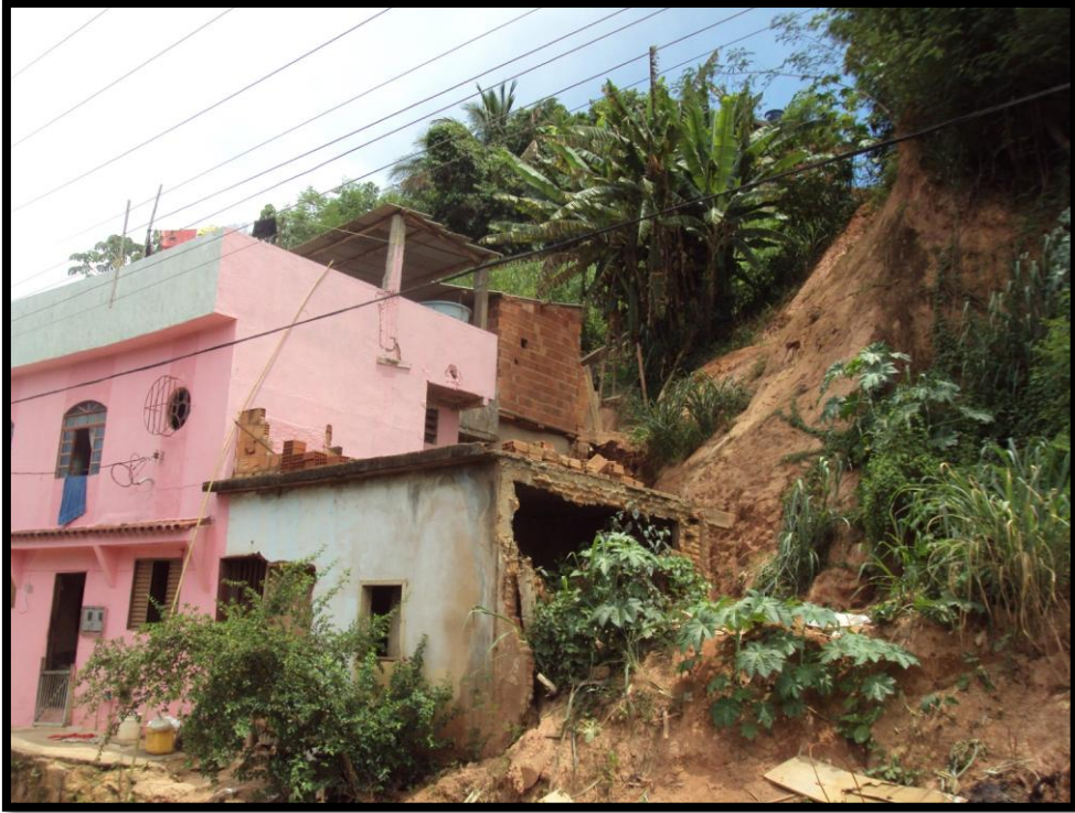
Foto 156 – Vista de parte do setor com detalhe para escorregamento pretérito que atingiu o domicílio e parte da via de acesso.
