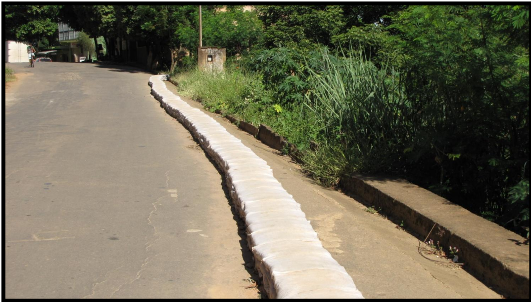
Foto 192 – Detalhe para outro trecho da Rua Francisco T. Filho parcialmente rompido.
