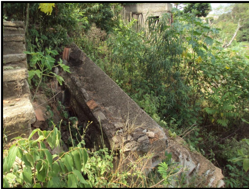
Foto 161 – Estrutura de acesso rompida no interior do setor de risco.
