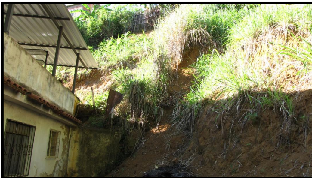
Foto 82 – Vista a partir do final da Rua 7 de setembro do mesmo domicílio descrito na foto anterior com detalhe para os indícios de movimentação da encosta (cicatriz de escorregamento e abatimentos).
