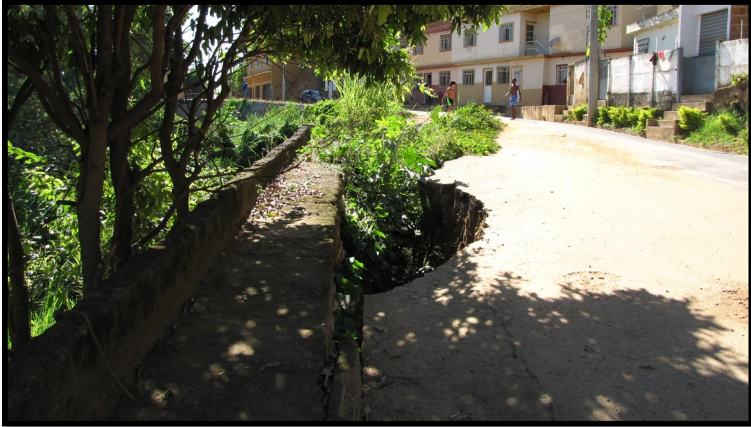
Foto 196 – Trecho da Rua Prefeito Francisco T. Filho parcialmente rompido com possibilidade de colapso.
