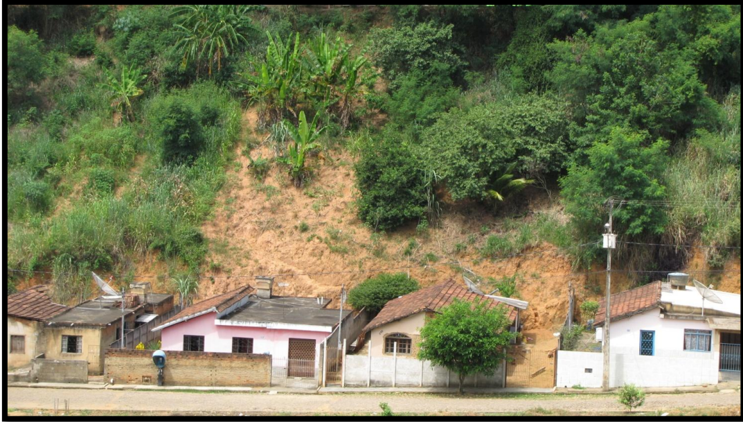
Foto 90 – Vista parcial do setor. Detalhe para extensão e altura da encosta, inclinação elevada da mesma e domicílios que ocuparam a base por meio de cortes.
