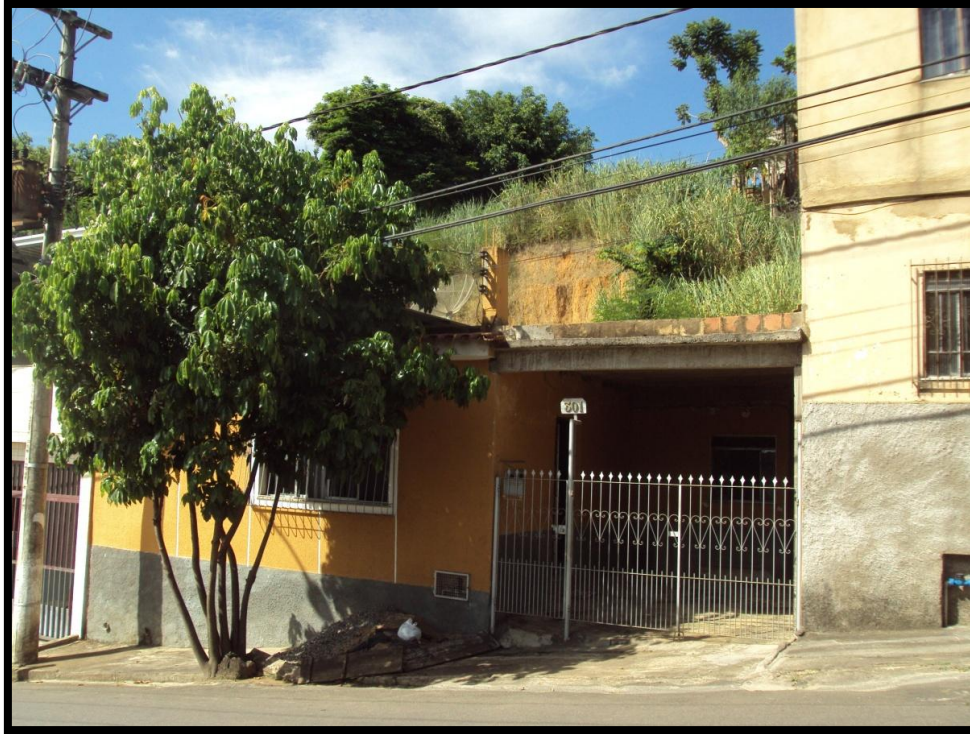
Foto 206 – Vista parcial do setor de risco. Detalhe para talude de corte verticalizado nos fundos do domicílio.
