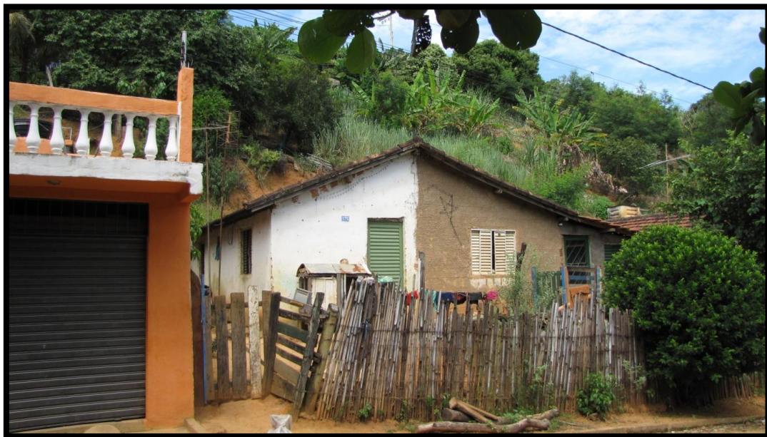
Foto 89 – Vista de parte do setor 2 de risco com detalhe para talude verticalizado nos fundos do domicílio padrão construtivo baixo do mesmo.
