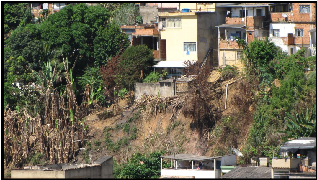
Foto 145 – Vista pontual do setor com detalhe para talude instável, presença de bananeiras e estruturas com possibilidade de colapso.
