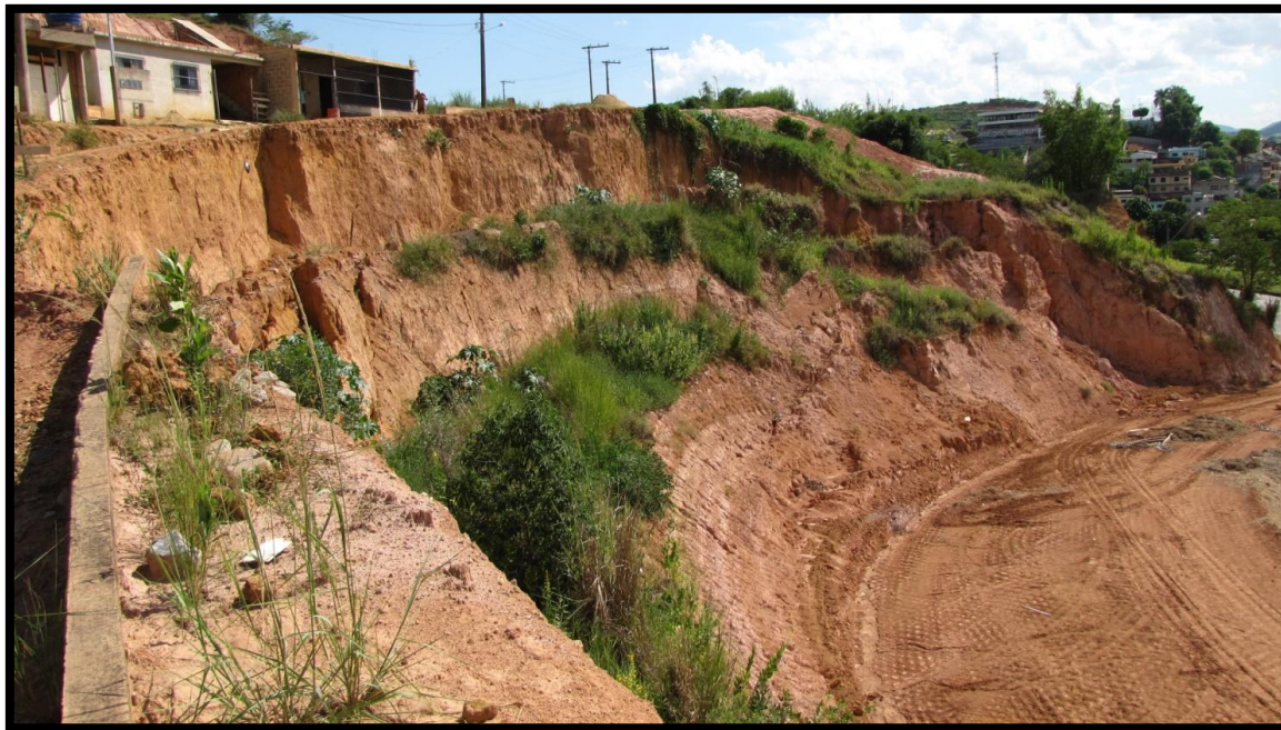
Foto 19 – Degraus de abatimento a montante da alça de acesso ao município cuja base é contida por uma estrutura do tipo gabião. Ressalta-se a progressão do processo geodinâmico e a possibilidade tanto de novas superfícies de ruptura serem formadas mais próximas aos domicílios do topo quanto do colapso da estrutura de gabião na base.
