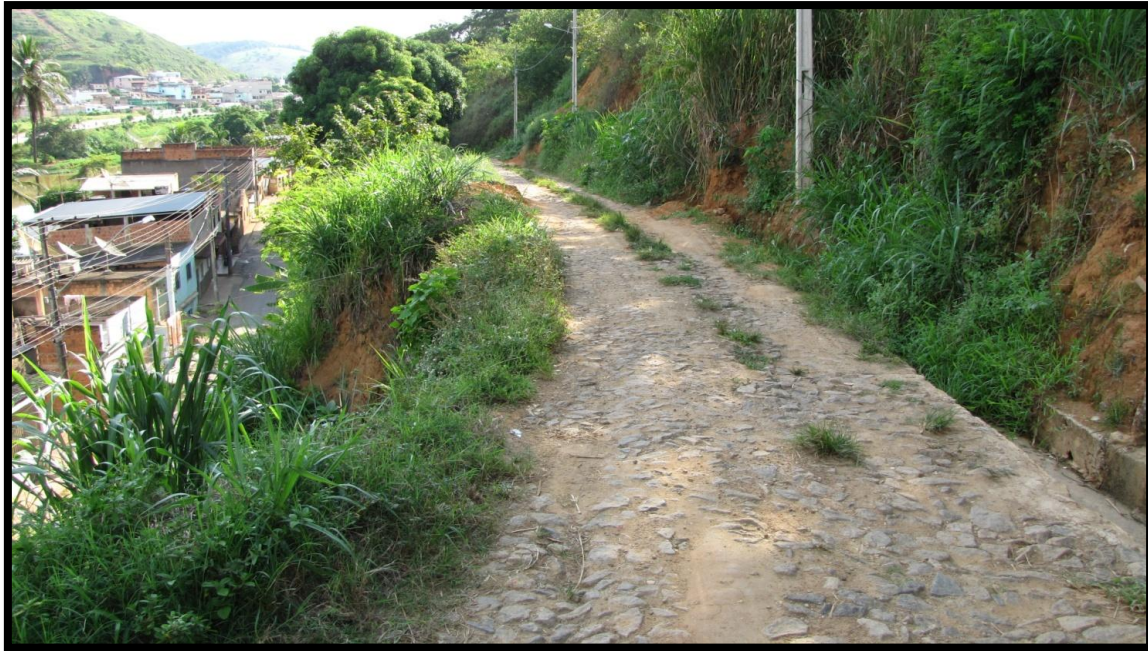
Foto 2 – Rua Benedito Videira com destaque para a canaleta de drenagem obstruída a direita da via e para uma cicatriz de escorregamento a esquerda e jusante da mesma.
