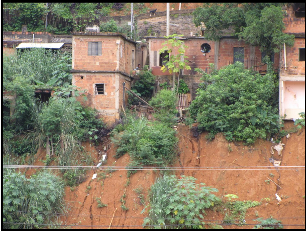
Foto 12 – Vista complementar a esquerda da foto 11 com detalhe para outros sulcos erosivos evoluídos sob os domicílios.
