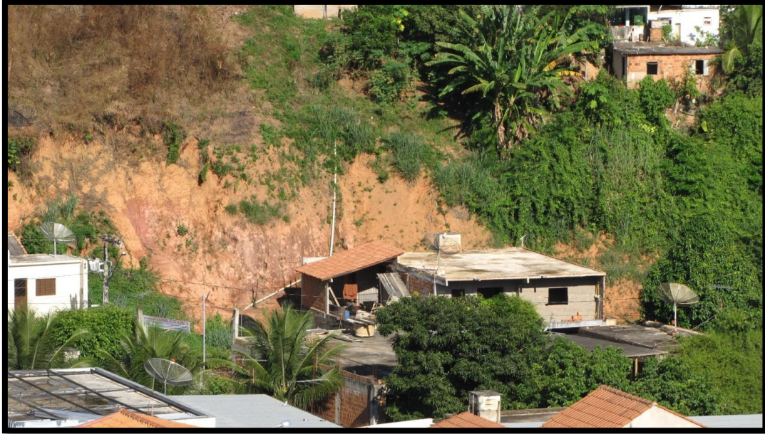
Foto 130 – Detalhe pontual do setor ilustrado na foto anterior destacando as cicatrizes de escorregamento nos fundos dos domicílios.
