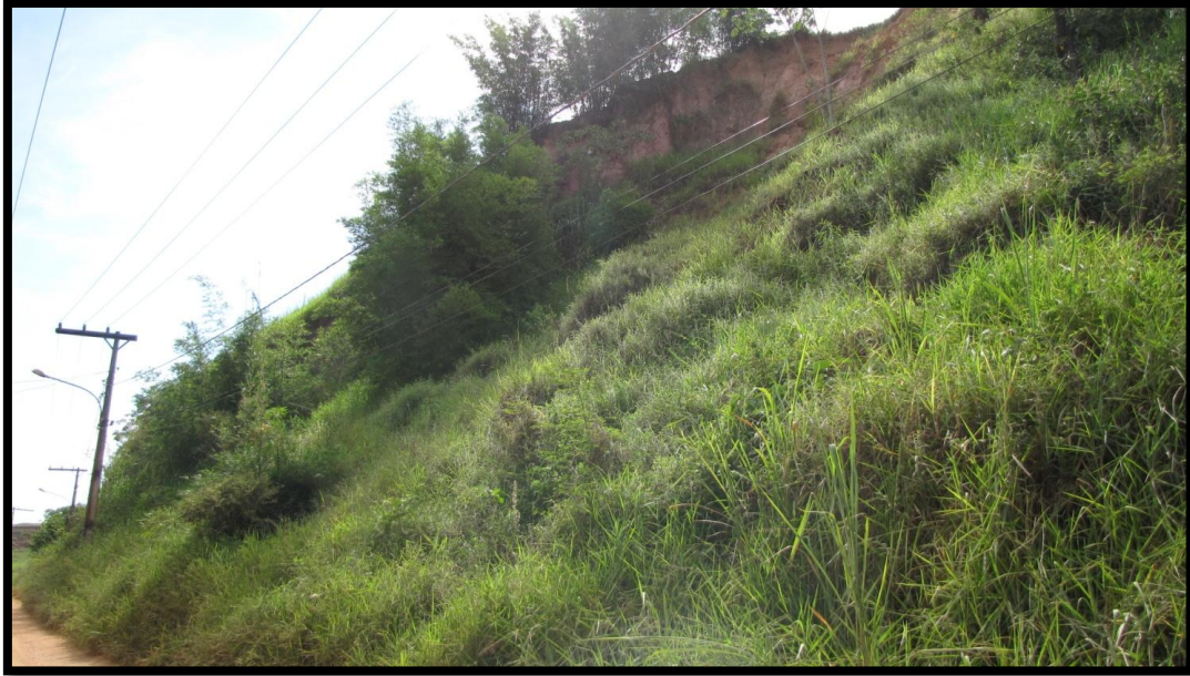
Foto 74 – Encosta a montante do setor de risco onde ocorrerem escorregamentos de solo. Suscetibilidade de deflagração de novos escorregamentos com volumes significativos de material.
