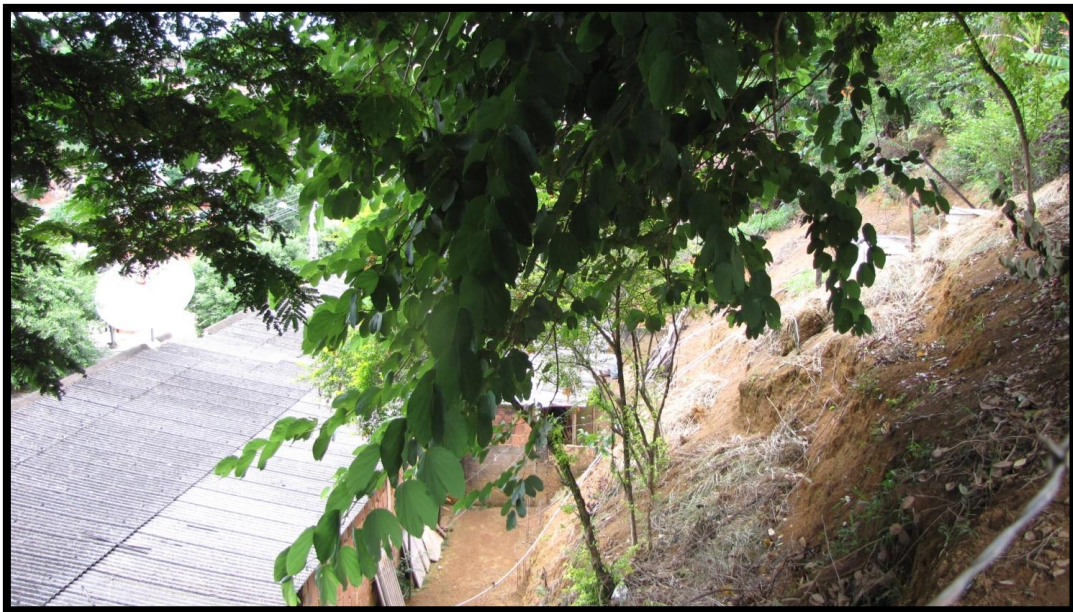
Foto 186 – Detalhe para talude inclinado e exposto mas sem indícios diretos de movimentação.
