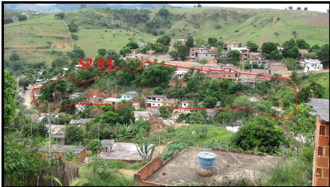
Foto 176 – Delimitação do setor 2 de risco geológico. Ocupação de baixo padrão construtivo na base e no topo.
