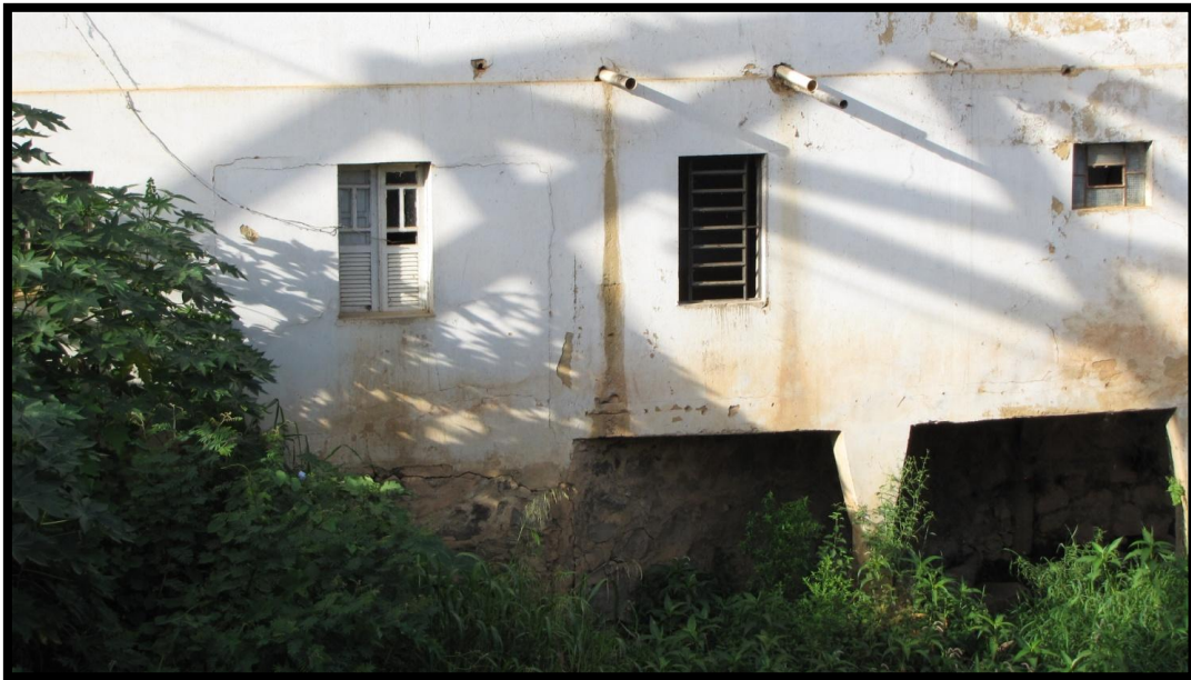
Foto 116 – Notar trincas na alvenaria do domicílio relacionadas a pequenos recalques.
