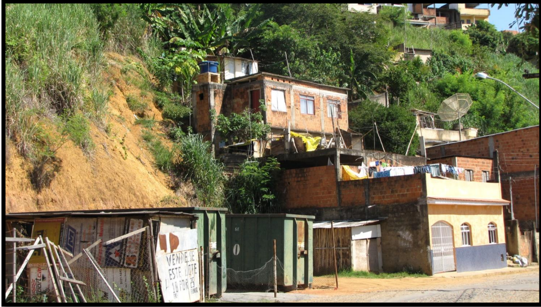
Foto 139 – Vista parcial do setor de risco. Domicílios escalonados em um trecho da encosta com suscetibilidade de ocorrerem escorregamentos.
