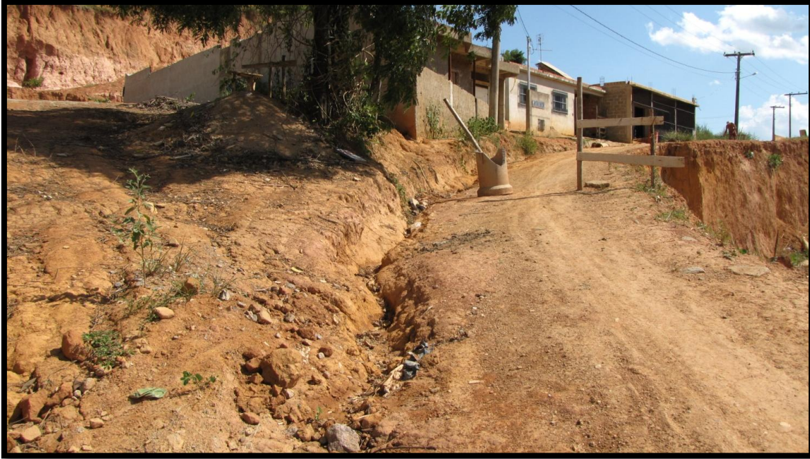
Foto 20 – Detalhe para a via veicular a montante da superfície de ruptura ilustrada na foto 19 atentando para a concentração do escoamento superficial a esquerda da via com possibilidade de formação de uma nova superfície de ruptura neste ponto.
