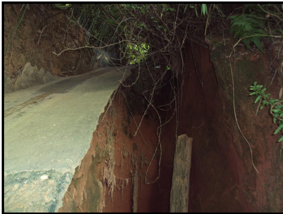
Foto 204 – Feição erosiva observada a jusante do lançamento das águas superficiais concentradas.
