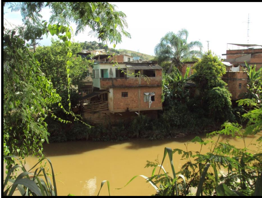
Foto 33 – Vista parcial do setor com detalhe para a ocupação adjacente ao canal com danos estruturais evidentes (trincas) na estruturas relacionadas a recalques.
