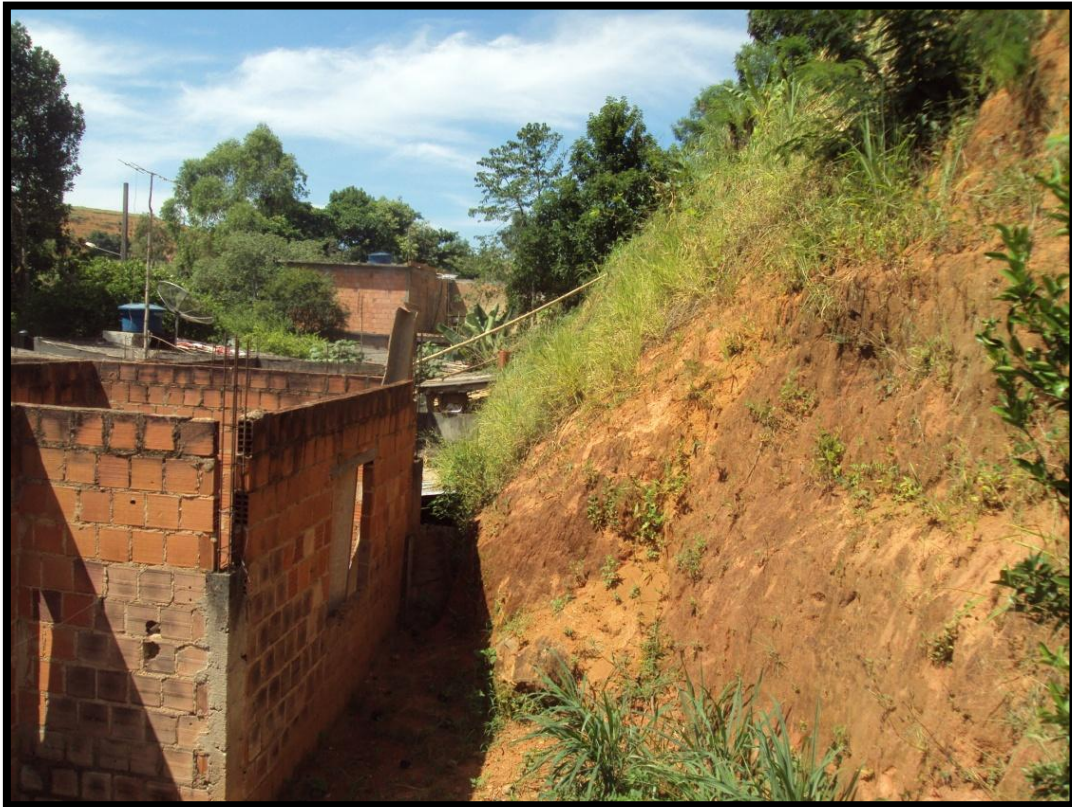
Foto 103 – Vista de parte do setor nos fundos de um dos domicílios. Detalhe para a inclinação acentuada da encosta.
