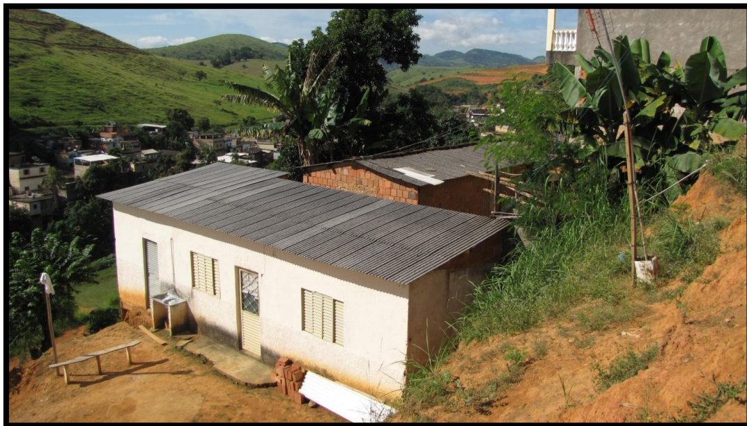
Foto 169 – Vista parcial do setor de risco. Corte verticalizado nos fundos do domicílio com afastamento inferior a 2,0 em relação ao mesmo.
