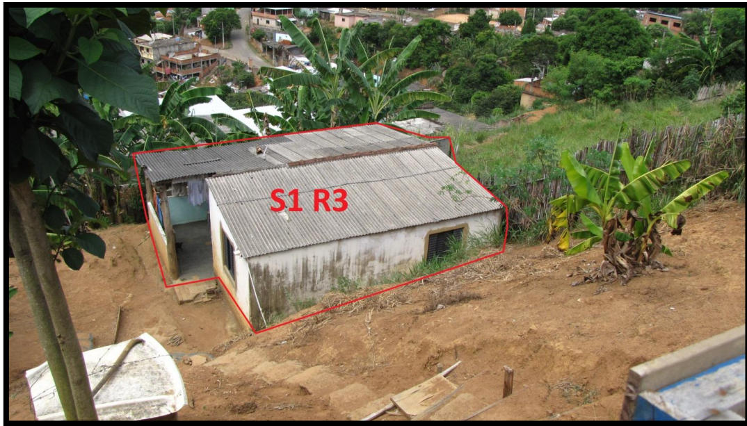
Foto 175 – Domicílio de baixo padrão construtivo e talude de corte instável.
