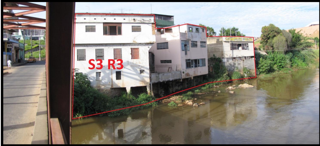
Foto 115 – Vista parcial do setor que abrange as duas margens. Estruturas dos domicílios construídas dentro do canal. Trincas na alvenaria e nas bases dos domicílios relacionadas a recalques que podem evoluir para o colapso total das edificações.
