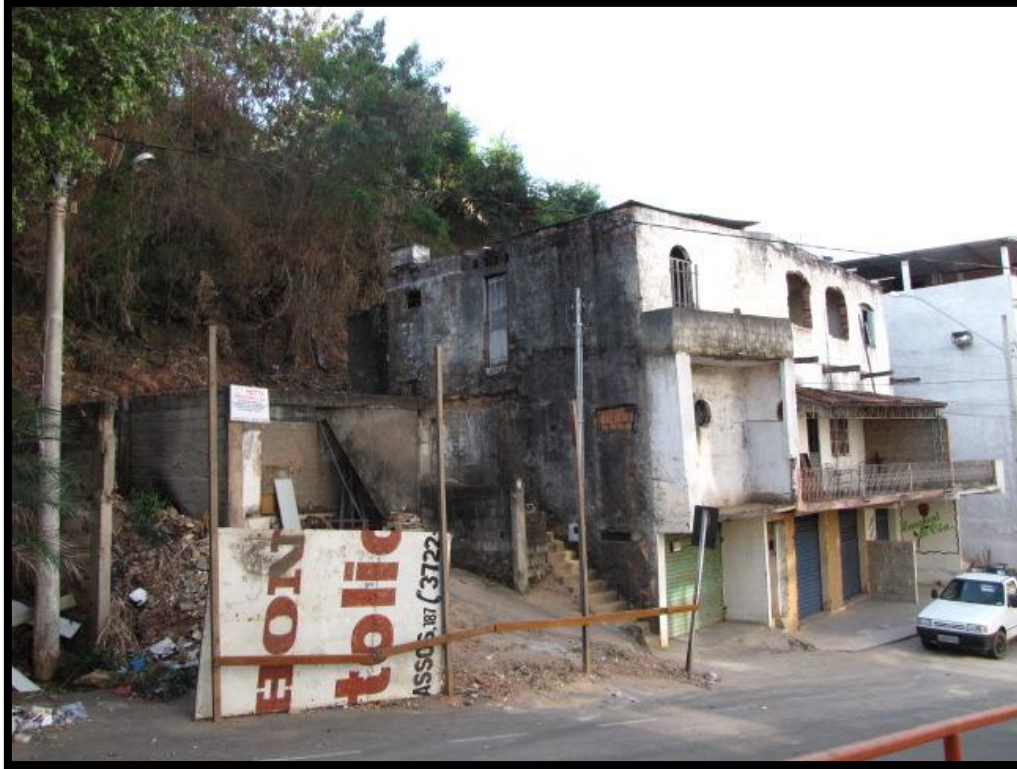
Foto 147 – Vista da base do setor. A esquerda tem-se um domicílio abandonado após a ocorrência de escorregamentos que atingiram os fundos do mesmo.
