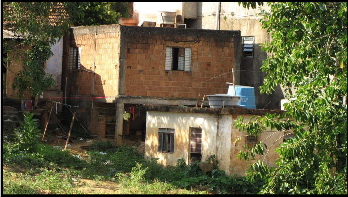
Foto 7 – Detalhe para as marcas na parede do domicílio de um dos eventos de cheia que atingiu 2,0m
