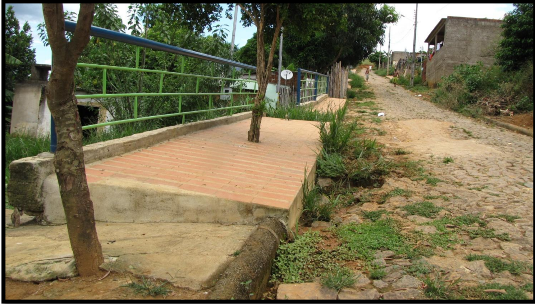
Foto 182 – Deformação do calçamento com possibilidade de colapso sobre os domicílios.
