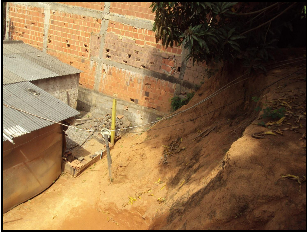
Foto 102 – Cicatriz de escorregamento nos fundos de um domicílio do setor resultado da alteração da geometria do talude.
