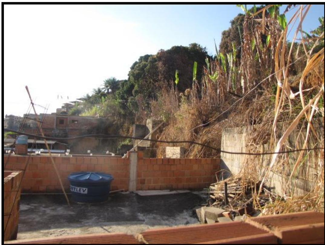
Foto 142 – Detalhe para a encosta nos fundos dos domicílios que ocupam a base onde constatou-se a possibilidade de ocorrerem escorregamentos pontuais de solo.
