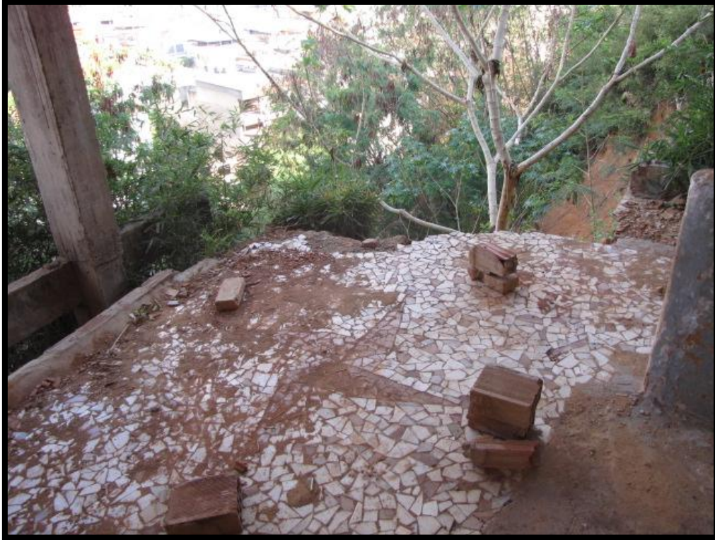
Foto 149 – Vista da crista da encosta com detalhe para o colapso parcial do domicílio.
