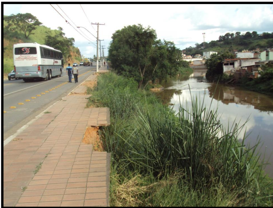
Foto 38 – Vista oposta da margem do Rio Muriaé adjacente a BR 356 sendo este trecho do canal naturalmente suscetível aos processos de solapamento (dinâmica fluvial) o que pode ser verificado pelo avanço da erosão que pode culminar na interdição de uma das pistas da BR.
