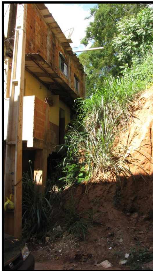
Foto 23 – Vista do final da Rua Marechal Floriano com detalhe para o domicílio construído adjacente a encosta e ao fato de já terem ocorrido escorregamentos de solo que atingiram a casa.
