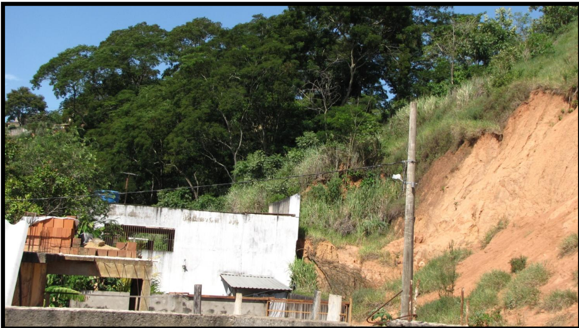
Foto 21 – Vista do final da Rua Helena Vegui com detalhe para volume de solo já escorregado nos fundos do domicílio.
