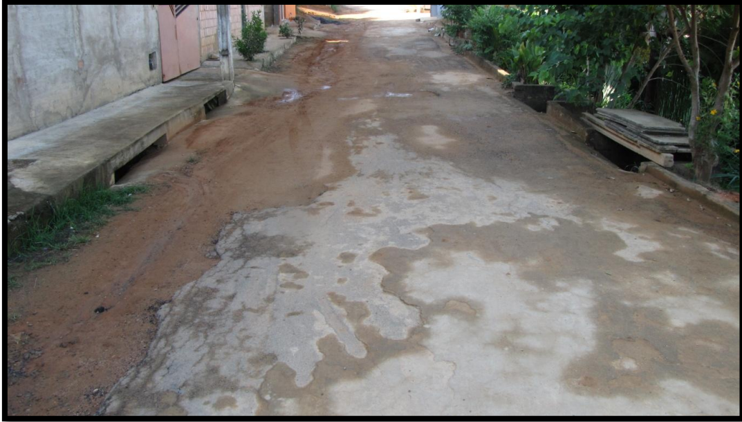
Foto 125 – Detalhe para o trecho ilustrado na foto anterior. Sistema de drenagem superficial para a captação e condução do escoamento das águas superficiais.
