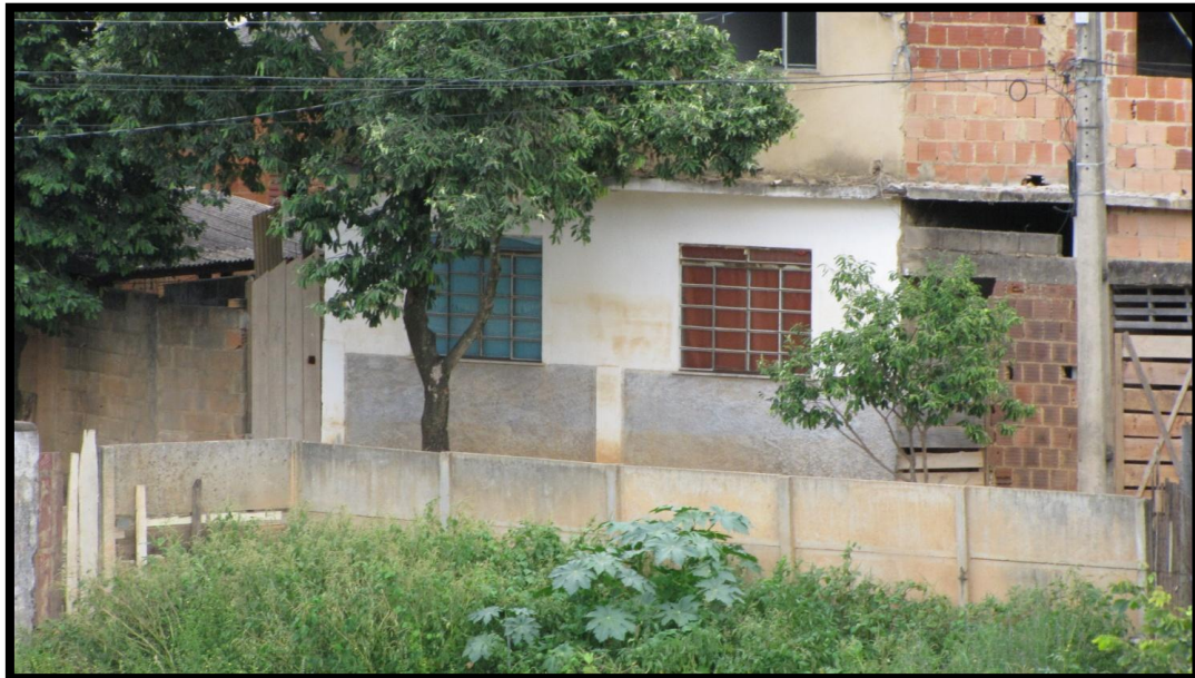
Foto 98 – Detalhe para a altura da marca do último episódio de inundação registrado nas paredes do domicílio (1,7m).
