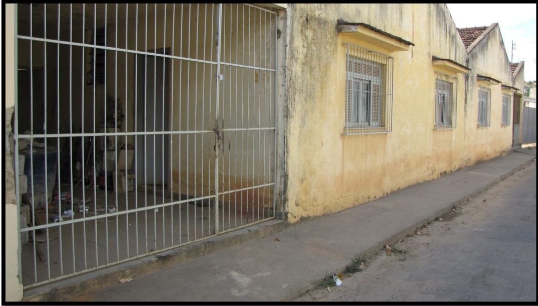
Foto 79 – Prédio na Rua Fritz Duvanel com detalhe para as marcas do episódio de inundação (60,0cm).
