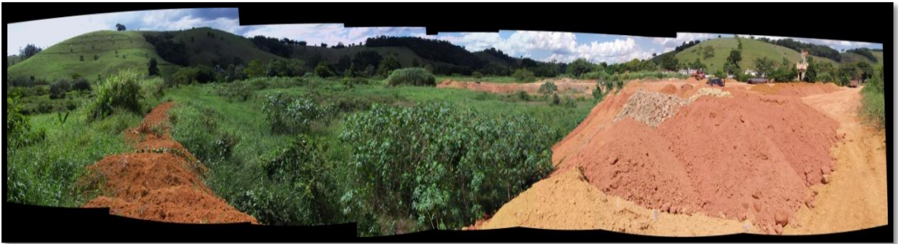
Foto 62 – Trecho da planície aluvionar do Rio Muriaé onde está sendo construído um aterro de grande porte que influenciará negativamente nos processos de inundação e solapamento a jusante do canal.
