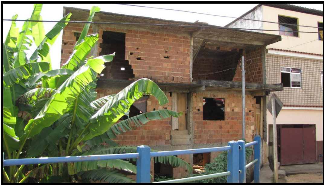
Foto 167- Domicílio Rua Hermes de Almeida após a ponte de ligação ente o Bairro Franco Suíço e Santana onde tem-se risco construtivo com possibilidade de colapso da estrutura.
