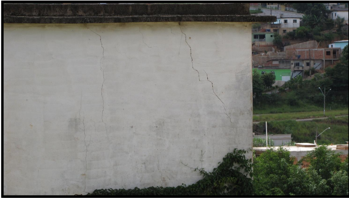
Foto 54 – Trincas na estrutura da edificação.
