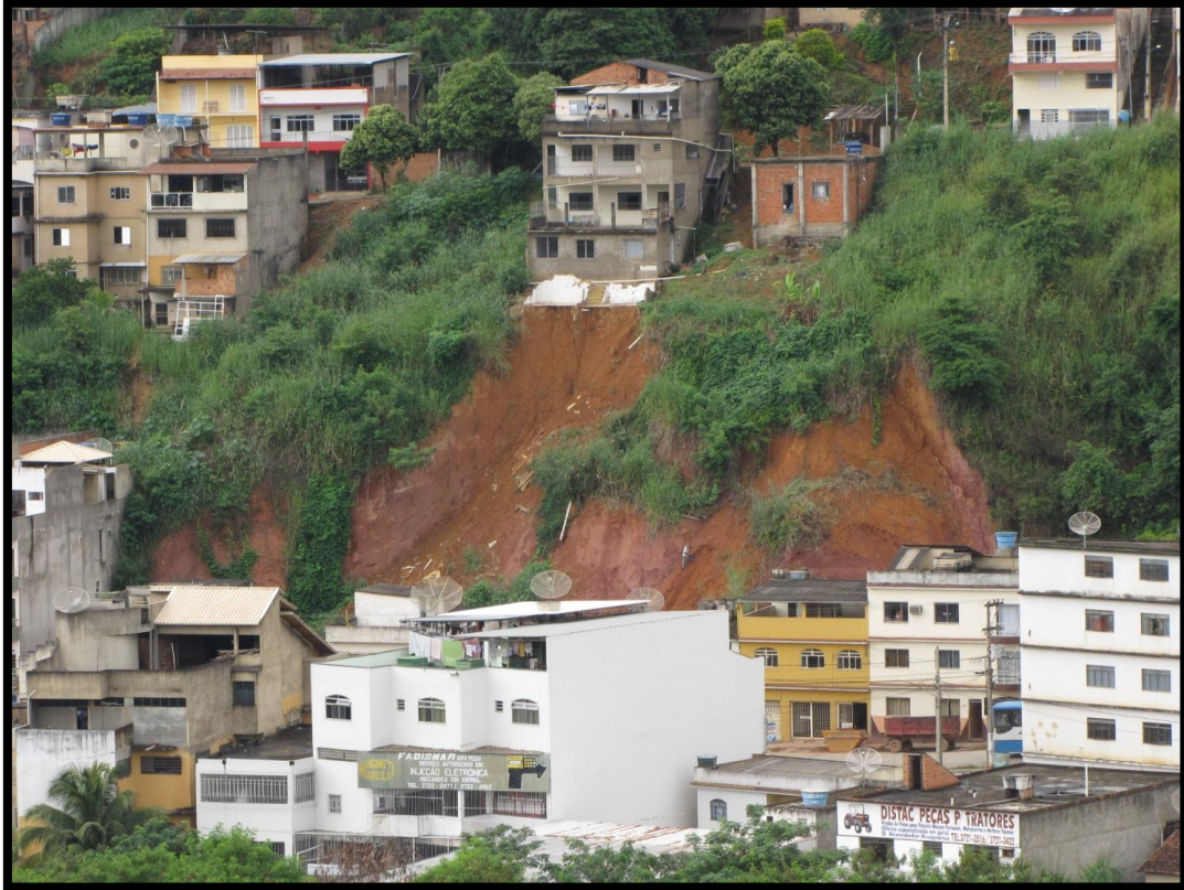
Foto 26 – Detalhe para as superfícies de ruptura dos escorregamentos anteriores que acarretaram no colapso de parte do domicílio que ocupa a crista.
