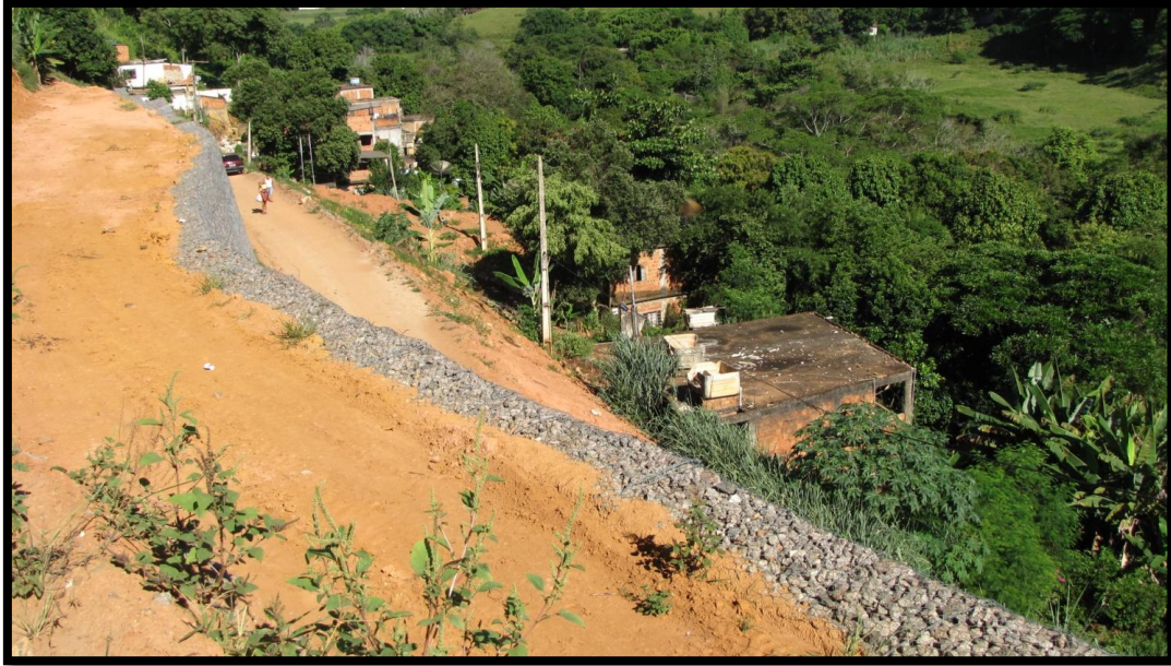
Foto 189 – Detalhe para estrutura do tipo gabião construída no setor que deve ser monitorada em decorrência da sobrecarga imposta pela mesma e não complementação da intervenção (proteção superficial vegetal, sistema de drenagem superficial etc).
