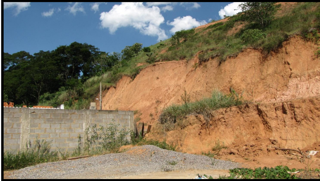
Foto 22 – Vista parcial da encosta nos final da Rua Helena Vegui. Descrição de vários processos erosivos lineares instalados, cicatrizes de escorregamento e degraus de abatimento.
