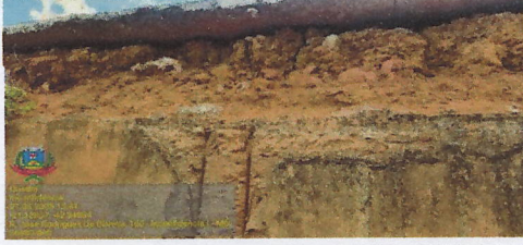
IMAGEM 6: MURO DA FACHADA SEM CONTINUIDADE DE VIGAS E PILARES LOCAL: QUADRA DO INCONFIDÊNCIA
