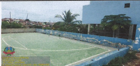
IMAGEM 4: PINTURA DA MURETA E DO PISO DESCASCANDO LOCAL: QUADRA DO INCONFIDÊNCIA
