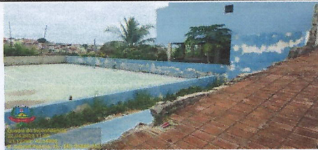
IMAGEM 2: MURETA EM RUÍNAS LOCAL: QUADRA DO INCONFIDÊNCIA
