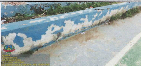
IMAGEM 3: MURETA DA QUADRA COM EMBOCO TRINCADO LOCAL: QUADRA DO INCONFIDÊNCIA
