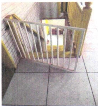
IMAGEM 5: GRADE COM PINTURA DESGASTADA LOCAL: E.M. JOSÉ MIGUEL MUAHAD
