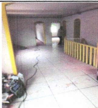
IMAGEM 11: GUARDA CORPO E PAREDES A SEREM PINTADAS LOCAL: E.M. JOSÉ MIGUEL MUAHAD
