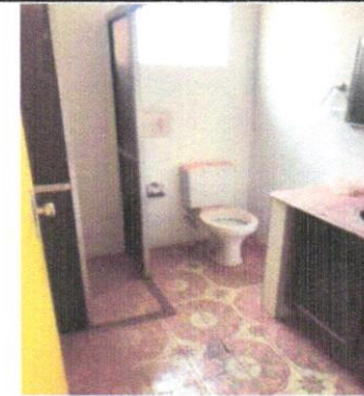
IMAGEM 10: BANHEIRO A SER PINTADO LOCAL: E.M. JOSÉ MIGUEL MUAHAD
