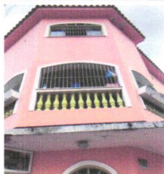
IMAGEM 3: BEIRAL E FACHADA COM PINTURA DESGASTADAS
