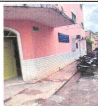
IMAGEM 2: BEIRAL COM EMBOÇO SOLTANDO
