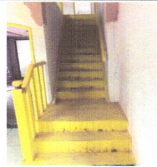
IMAGEM 4: ESCADA COM PINTURA SOLTANDO
