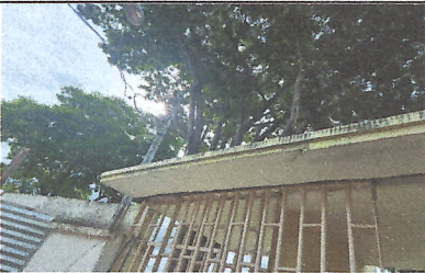
IMAGEM 3: ÁREA SEM EMBOÇO NO TETO LOCAL: CEMITÉRIO SENHOR DO BONFIM
