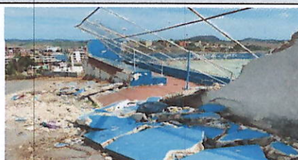
IMAGEM 2: ALAMBRADO DERRUBADO LOCAL: QUADRA DO INCONFIDÊNCIA
