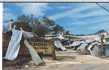
IMAGEM 4: COBERTURA DERRUBADA LOCAL: QUADRA DO INCONFIDÊNCIA
