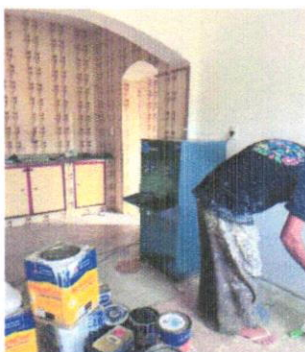
IMAGEM 3: PAREDES SEM PINTURA LOCAL: E.M. JOSE MIGUEL MUAHAD
