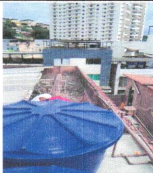
IMAGEM 1: FALTA DE RUFO NAS PAREDES DA COBERTURA LOCAL: E.M. JOSÉ MIGUEL MUAHAD
