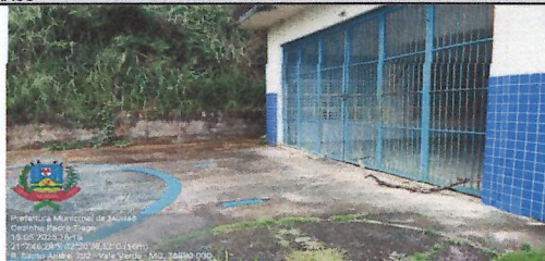
IMAGEM 4: PISO ELEVADO POR RAIZES LOCAL: PADRE TIAGO
