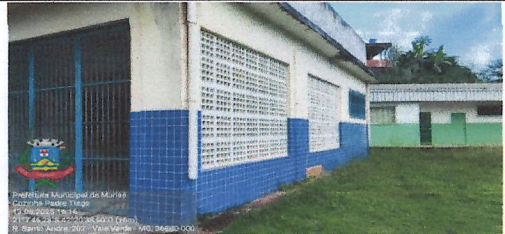
IMAGEM 5: GUARDA-CORPO COM PINTURA DANIFICADA LOCAL: PADRE TIAGO
