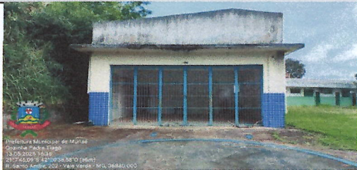
IMAGEM 3: PISO ELEVADO POR RAIZES LOCAL: PADRE TIAGO
