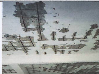
IMAGEM 4: LAJE DETERIORADA LOCAL: CAPELA MACUCO
