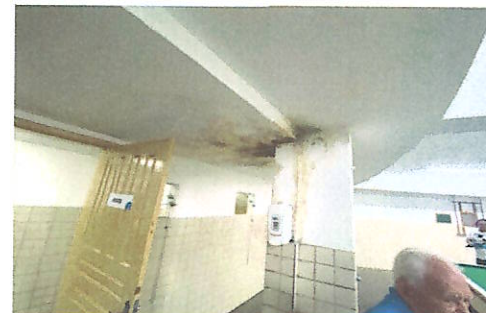
IMAGEM 4: INFILTRAÇÃO SALA SINUCA LOCAL: PRAÇA JOÃO PINHEIRO
