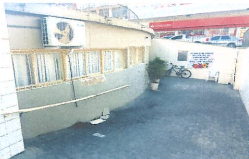
IMAGEM 3: DESCOLAMENTO DA PINTURA LOCAL: PRAÇA JOÃO PINHEIRO
