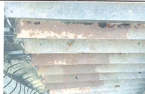
IMAGEM 2: ESCADA METÁLICA DETERIORADA LOCAL: PRAÇA JOÃO PINHEIRO
