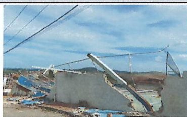
IMAGEM 3: TUBULAÇÃO E ALAMBRADO DERRUBADOS LOCAL: QUADRA DO INCONFIDÊNCIA
