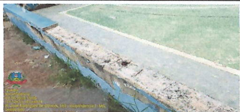
IMAGEM 5: MURETA SEM REVESTIMENTO LOCAL: QUADRA DO INCONFIDÊNCIA
