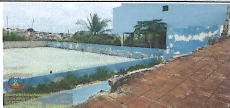
IMAGEM 2: MURETA EM RUÍNAS LOCAL: QUADRA DO INCONFIDÊNCIA
