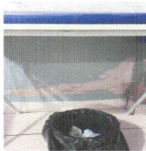
IMAGEM 6: PAREDE COM PINTURA DANIFICADA (TERREO SECRETARIA) LOCAL: E.M. RICARDO OLIVEIRA MORAIS DE AZEVEDO
