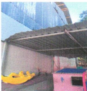
IMAGEM 9: TELHADO DANIFICADO PATIO DESCOBERTO LOCAL: E.M. RICARDO OLIVEIRA MORAIS DE AZEVEDO
