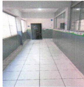
IMAGEM 13: PISO MANCHADO NO 2º PAV. LOCAL: E.M. RICARDO OLIVEIRA MORAIS DE AZEVEDO
