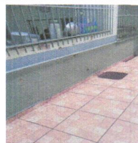
IMAGEM 4: HALL DE ENTRADA COM PINTURA SOLTANDO LOCAL: E.M. RICARDO OLIVEIRA MORAIS DE AZEVEDO
