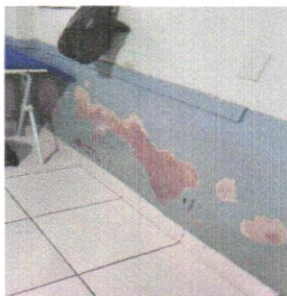
IMAGEM 5: PAREDE APRESENTANDO UMIDADE (CRECHE 01 TERREO) LOCAL: E.M. RICARDO OLIVEIRA MORAIS DE AZEVEDO
