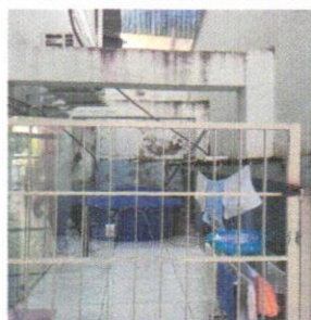
IMAGEM 3: LATERAL DA ESCOLA COM PINTURA DESGASTADA LOCAL: E.M. RICARDO OLIVEIRA MORAIS DE AZEVEDO
