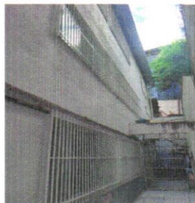
IMAGEM 2: FACHADA LATERAL COM INFILTRAÇÃO NA PARTE DOS FUNDOS LOCAL: E.M. RICARDO OLIVEIRA MORAIS DE AZEVEDO
