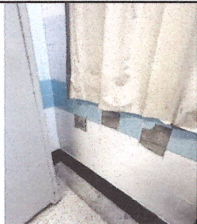
IMAGEM 3: CONSULTÓRIO, REVESTIMENTO A SER TROCADO. LOCAL: SETOR DE EPIDEMIOLOGIA
