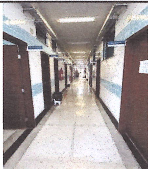
IMAGEM 1: CORREDOR DOS CONSULTÓRIOS, SOLTANDO REVESTIMENTOS LOCAL: SETOR DE EPIDEMIOLOGIA
