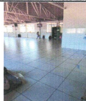
IMAGEM 12: AUSENCIA DE PISO PODOATIL LOCAL: E.M. ODALEIA MORAIS DE AZEVEDO
