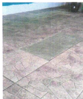
IMAGEM 14: PISO CERÂMICO DANIFICADO LOCAL: E.M. ODALEIA MORAIS DE AZEVEDO
