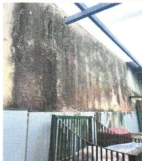
IMAGEM 1: PAREDE COM INFILTRAÇÃO LOCAL: E.M. ODALEIA MORAIS DE AZEVEDO
