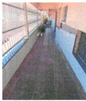
IMAGEM 4: AUSENCIA DE CORRIMAO NA RAMPA LOCAL: E.M. ODALEIA MORAIS DE AZEVEDO
