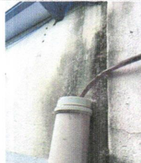
IMAGEM 6: PAREDE COM INFILTRAÇÃO LOCAL: E.M. ODALEIA MORAIS DE AZEVEDO
