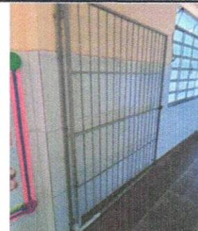
IMAGEM 10: PORTAO EM GRADE A SER PINTADA LOCAL: E.M. ODALEIA MORAIS DE AZEVEDO
