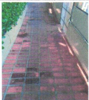
IMAGEM 5: PISO RAMPA A SER DEMOLIDO LOCAL: E.M. ODALEIA MORAIS DE AZEVEDO
