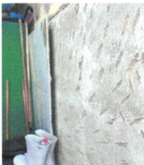
IMAGEM 3: REVESTIMENTO SOLTANDO LOCAL: E.M. ODALEIA MORAIS DE AZEVEDO
