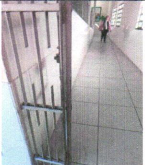
IMAGEM 7: PISO LISO E AUSENCIA DE CORRIMAO LOCAL: E.M. ODALEIA MORAIS DE AZEVEDO
