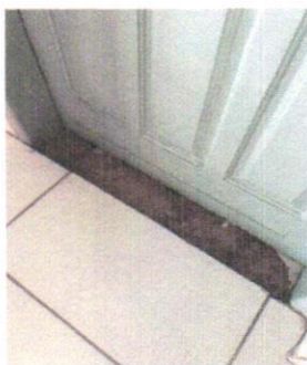
IMAGEM 13: AUSÊNCIA DE SOLEIRA LOCAL: E.M. ODALEIA MORAIS DE AZEVEDO
