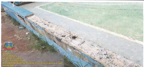
IMAGEM 5: MURETA SEM REVESTIMENTO LOCAL: QUADRA DO INCONFIDÊNCIA
