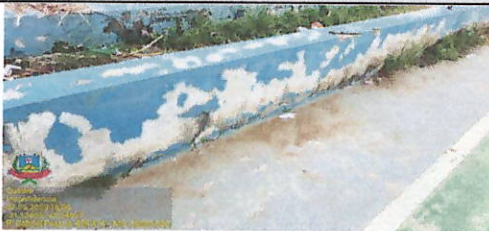
IMAGEM 3: MURETA DA QUADRA COM EMBOÇO TRINCADO LOCAL: QUADRA DO INCONFIDÊNCIA
