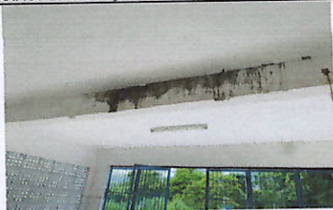
IMAGEM 1: INFILTRAÇÃO NA LAJE DO TELHADO LOCAL: PADRE TIAGO
