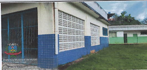
IMAGEM 5: GUARDA-CORPO COM PINTURA DANIFICADA LOCAL: PADRE TIAGO
