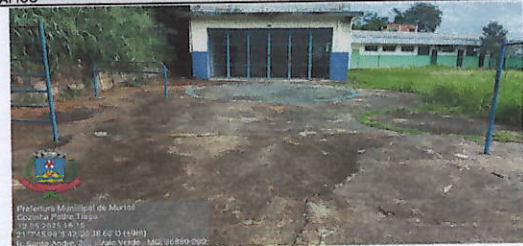
IMAGEM 6: GUARDA-CORPO COM PINTURA DANIFICADA LOCAL: PADRE TIAGO
