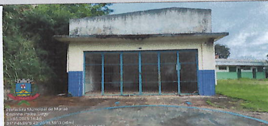
IMAGEM 3: PISO ELEVADO POR RAIZES LOCAL: PADRE TIAGO
