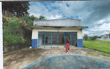
IMAGEM 2: FACHADA EXTERNA COM PINTURA DESGASTADA LOCAL: PADRE TIAGO
