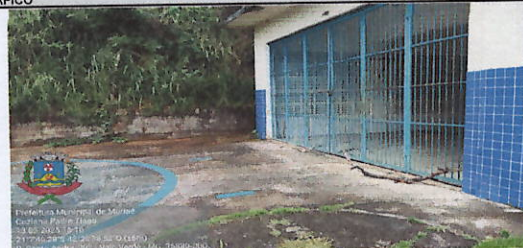
IMAGEM 4: PISO ELEVADO POR RAIZES LOCAL: PADRE TIAGO
