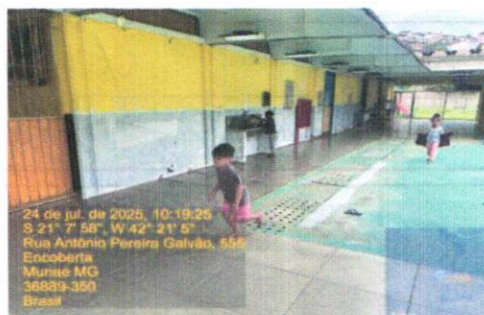
IMAGEM 4: PINTURA DO PÁTIO INTERNO DESGASTADA LOCAL: E.M. JOAQUIM RIBEIRO DE CARVALHO
