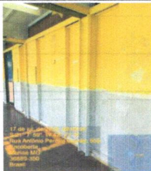
IMAGEM 3: PINTURA DO PÁTIO INTERNO DESGASTADA LOCAL: E.M. JOAQUIM RIBEIRO DE CARVALHO
