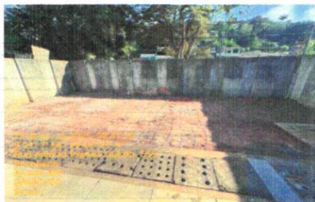
IMAGEM 1: DRENOS EXTERNOS DO SOLÁRIO COM SUPERFÍCIE IRREGULAR LOCAL: E.M. JOAQUIM RIBEIRO DE CARVALHO
