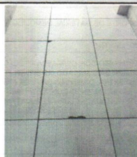
IMAGEM 2: PISO CERÂMICO QUEBRADO NO CORREDOR LOCAL: E.M. ZULEIMA CÉSAR DE ARAÚJO
