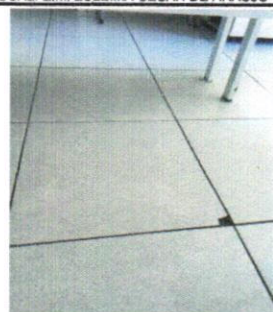
IMAGEM 4: PISO CERÂMICO QUEBRADO NO REFEITÓRIO LOCAL: E.M. ZULEIMA CÉSAR DE ARAÚJO
