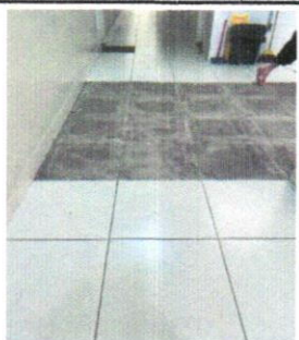
IMAGEM 3: PISO CERÂMICO SOLTO NO PATIO LOCAL: E.M. ZULEIMA CÉSAR DE ARAÚJO
