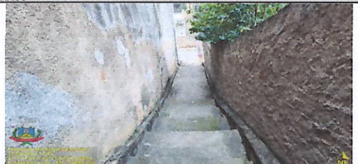
IMAGEM 6: INEXISTÊNCIA DE CORRIMÃO LOCAL: ESCADÃO RUA MIRADOURO COM RUA G. SCOPARO
