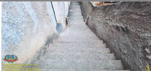
IMAGEM 5: PAREDE SEM ACABAMENTO E DEGRAUS FORA DE PADRÃO LOCAL: ESCADÃO RUA MIRADOURO COM RUA G. SCOPARO
