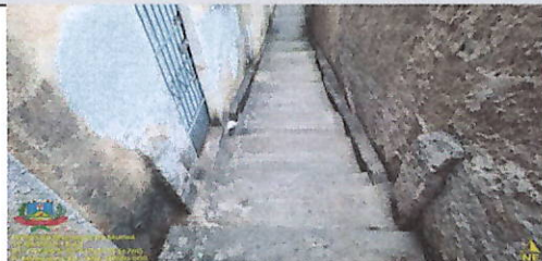
IMAGEM 3: PAREDE SEM ACABAMENTO LOCAL: ESCADÃO RUA MIRADOURO COM RUA G. SCOPARO
