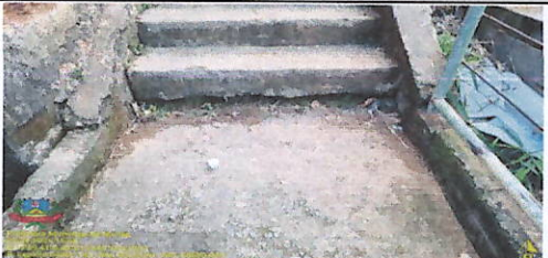
IMAGEM 5: DEGRAUS FORA DE PADRÃO LOCAL: ESCADÃO RUA NEWTON RESENDE/SÃO CRISTÓVÃO
