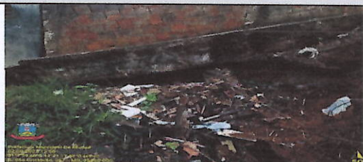
IMAGEM 2: BASE DA ESCADA DETERIORADA LOCAL: ESCADÃO RUA NEWTON RESENDE/SÃO CRISTÓVÃO
