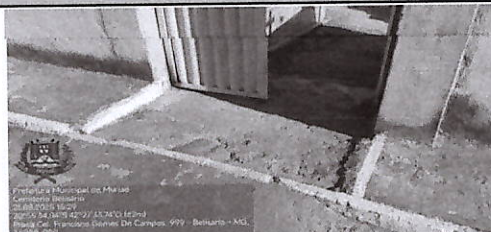
IMAGEM 2: ACESSO COM SUPERFÍCIE IRREGULAR DO CEMITÉRIO LOCAL: CEMITÉRIO BELISÁRIO
