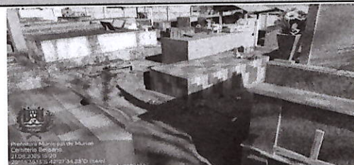
IMAGEM 3: MURO LATERAL NOS FUNDOS E ENTULHOS LOCAL: CEMITÉRIO BELISÁRIO
