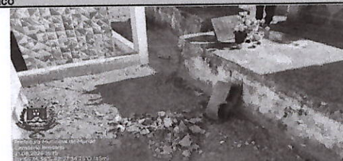
IMAGEM 6: ENTULHOS NOS ACESSOS LOCAL: CEMITÉRIO BELISÁRIO
