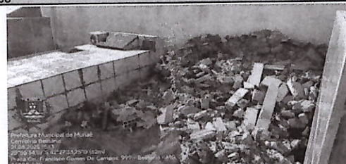
IMAGEM 4: MURO LATERAL NOS FUNDOS E ENTULHOS LOCAL: CEMITÉRIO BELISÁRIO
