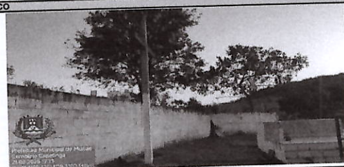
IMAGEM 6: ENTULHOS NOS FUNDOS E PINTURA DESGASTADA LOCAL - CEMITÉRIO CAPETINGA
