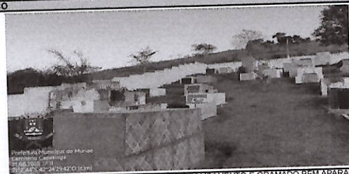
IMAGEM 4: MURO LATERAL SINAIS DE TOMBAMENTO E GRAMADO BEM APARADO LOCAL - CEMITÉRIO CAPETINGA
