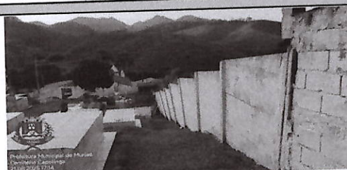
IMAGEM 5: MURO DE PLACA COM SINAIS DE TOMBAMENTO LOCAL - CEMITÉRIO CAPETINGA
