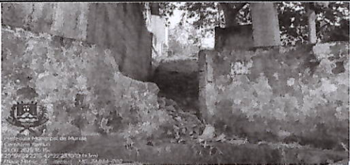
IMAGEM 5: CANALETA COM ENTULHOS LOCAL: CEMITÉRIO ITAMURI
