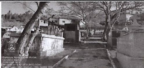
IMAGEM 3: MEIOS-FIOS COM DESGASTE NA CAIAÇÃO LOCAL: CEMITÉRIO ITAMURI
