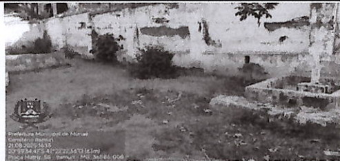
IMAGEM 2: MUROS DE DIVISA COM DEFEITOS NOS REVESTIMENTOS LOCAL: CEMITÉRIO ITAMURI
