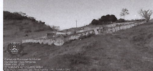
IMAGEM 6: MURO LATERAL INFERIOR DANIFICADO LOCAL: CEMITÉRIO DE SÃO FERNANDO
