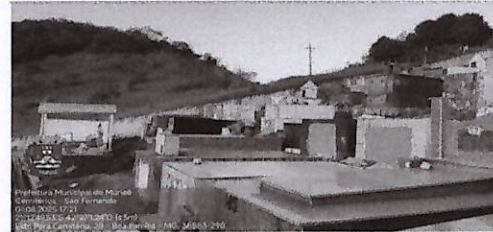
IMAGEM 4: MURO LATERAL INFERIOR DANIFICADO LOCAL: CEMITÉRIO DE SÃO FERNANDO
