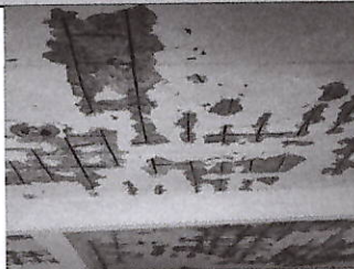
IMAGEM 4: LAJE DETERIORADA LOCAL: CAPELA MACUCO
