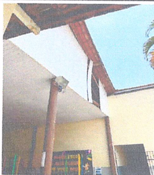
IMAGEM 1: MANUTENÇÃO E. M. MARIA DO CARMO C. CASTRO LOCAL: FORRO - COBERTURA
